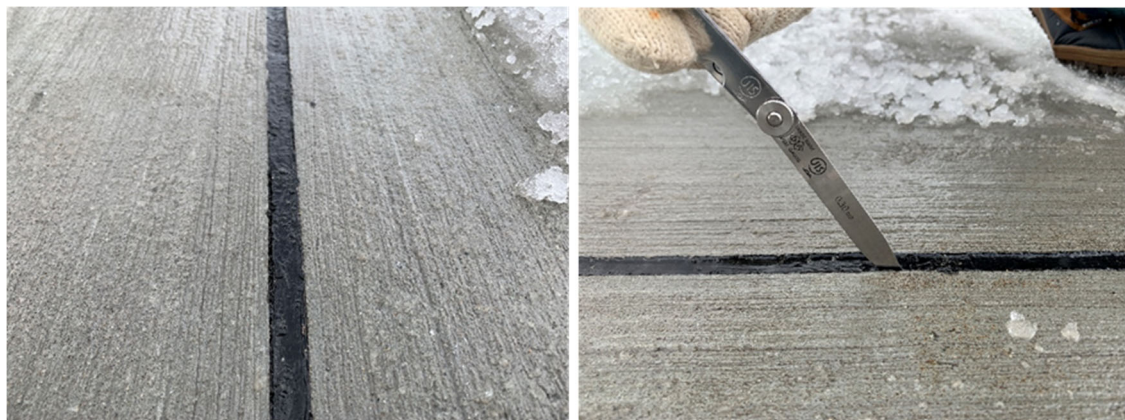
写真- 6.5.2 半年経過後の状況
