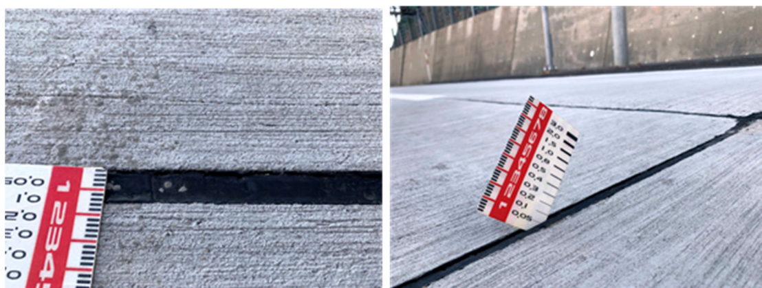
写真- 6.5.1 2ヶ月経過後の状況
