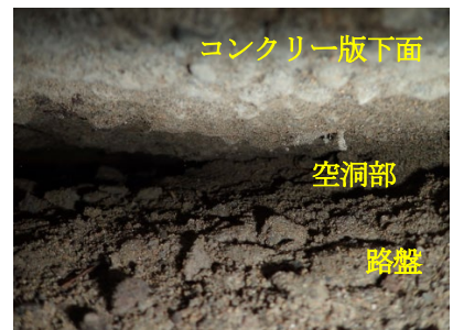
⑥ 模擬空洞内部
