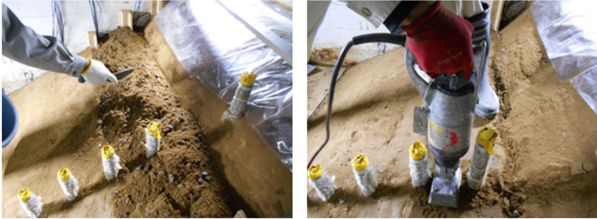
図 2.4.17 左：礫混合土置換範囲整形状況、右：礫混合土置換範囲締固め状況
