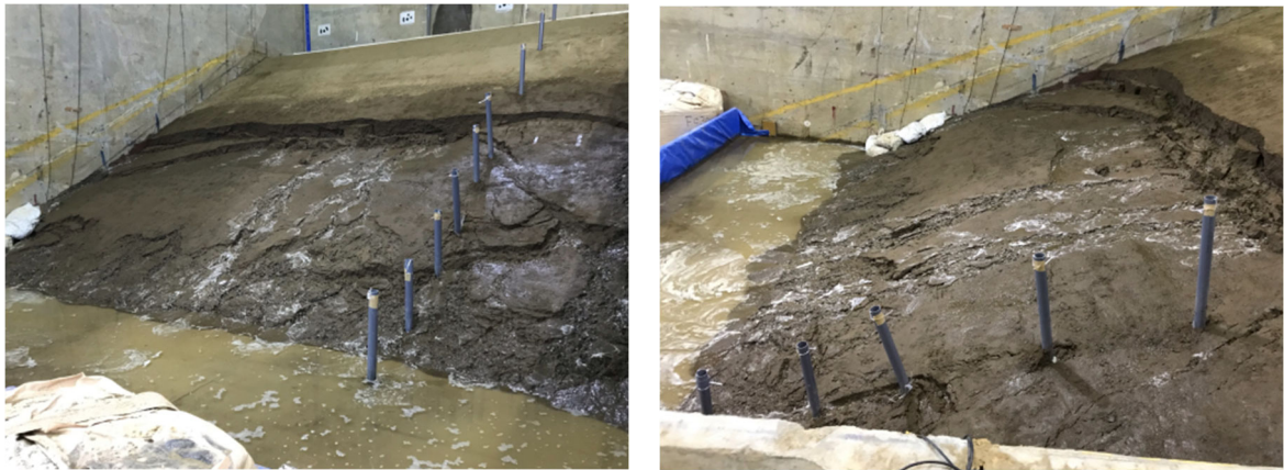
図 3.5.82 実験 2 日目実験終了時の状況 (左：礫混合土の滑動状況、右：クラックからの流水の状況)
