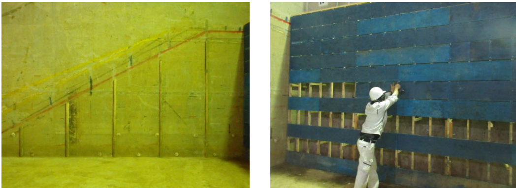
図 3.4.1 左：ルーフィング対策状況、右：給水槽構築状況（マット設置前）
