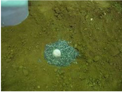
図 3.4.13 間隙水圧計設置状況
