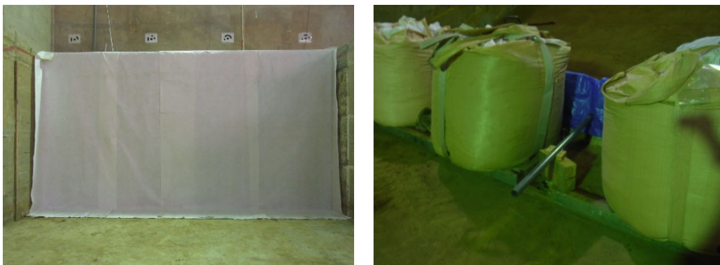
図 3.4.2 左：給水槽構築状況（マット設置後）、右：排水パイプ設置状況
