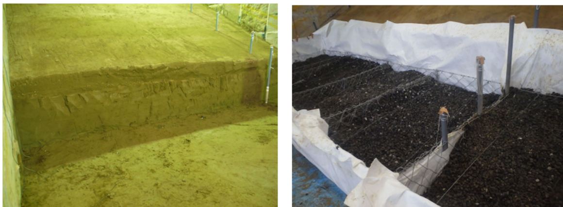
図 3.4.5 左：礫混合土置換部付近解体状況、右：ドレーン工構築状況
