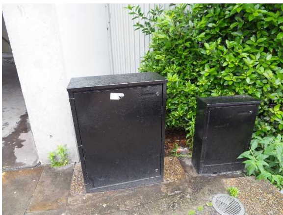
写真-3.6 小型で分割された地上機器（イギリス）
