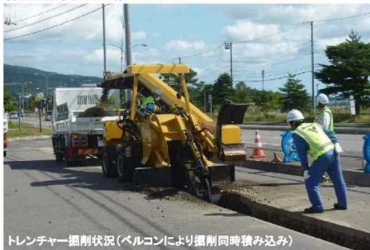
トレンチャー掘削状況(バルコンにより掘削同時積み込み)
