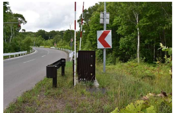
写真-2.8 車道路肩部の地上機器と車両防護設備
