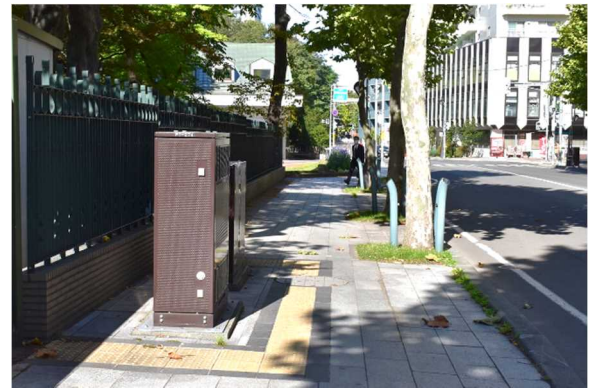
写真-3.1 地上機器が歩行や見通しを阻害している例
