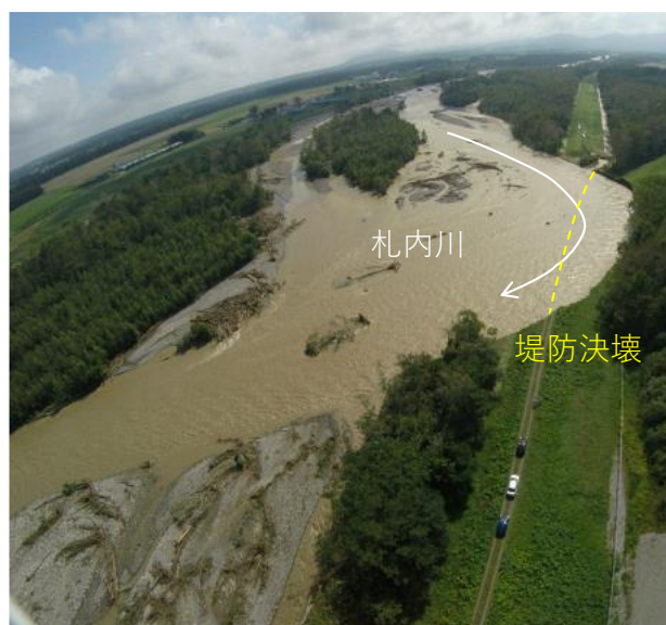
写真-1 札内川で発生した堤防決壊 (2016年出水、帯広開発建設部提供)
