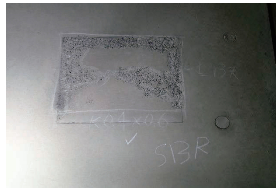
写真-3.3.2 アーチ部「その他」でのうき・はく離発生例
