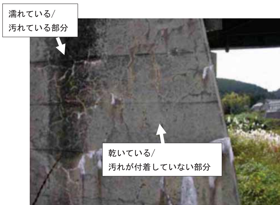
写真 4-13-2 ひびわれ部分のコンクリートが湿潤/乾燥による色調差が大きい場合
