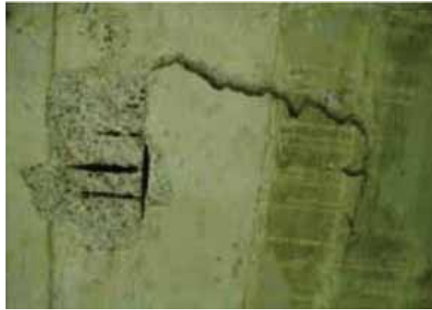
写真 4-9-2 段差のついたひびわれが視認され「うき」と把握できる事例
