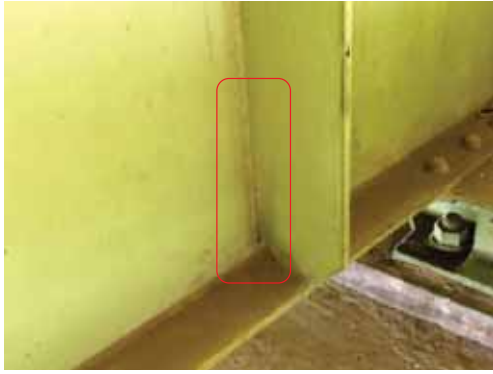
UAV で撮影した動画上の塗膜割れ
