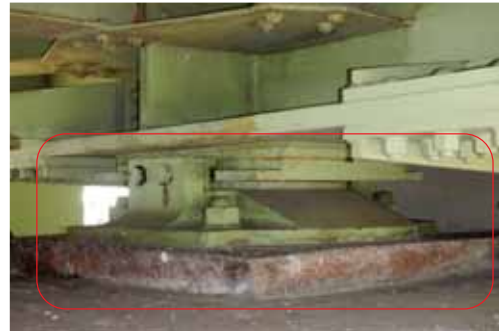
近接目視点検の支承の腐食
