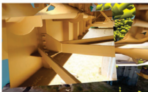
ガセット部分の3次元データと写真の重畳
