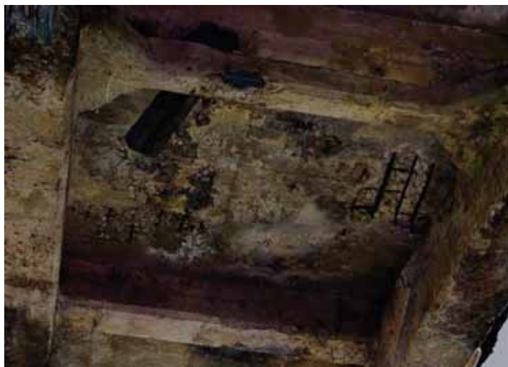
図 4-16-2 ドローン撮影後における橋梁の復元（床版の剥離・鉄筋露出）
