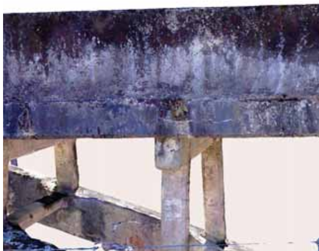
図 4-16-3 ドローン撮影後における橋梁の復元（橋脚のひびわれ）
