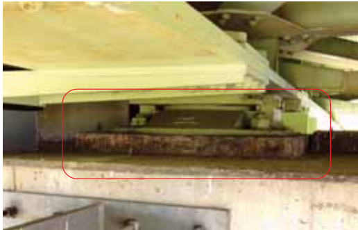
UAV で撮影した動画上の支承の腐食
