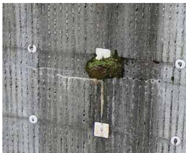
図 4-16-4 ドローン撮影後における橋梁の復元（橋脚コンクリート表面）
