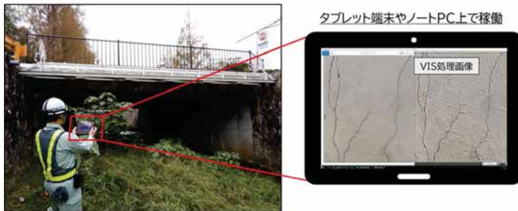
図 4-13-6 損傷発見の支援イメージ
