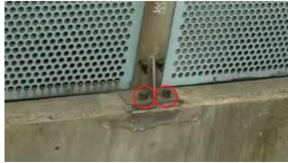
ボルトの余長不足
