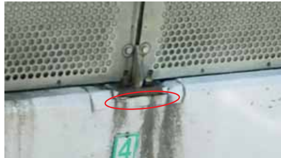
ベースプレートの浮き
