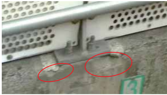
モルタルの剥離
