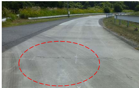
写真-4.2.8 角欠け発生位置(工区1502)
