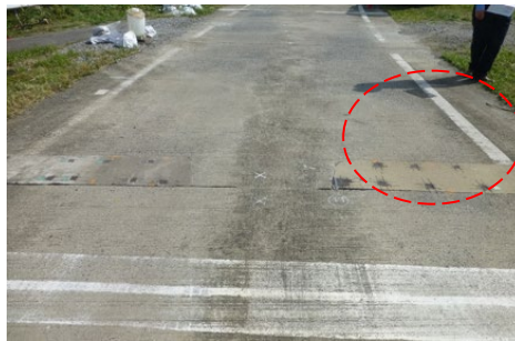
写真-4.2.10 目地材の破損発生位置
