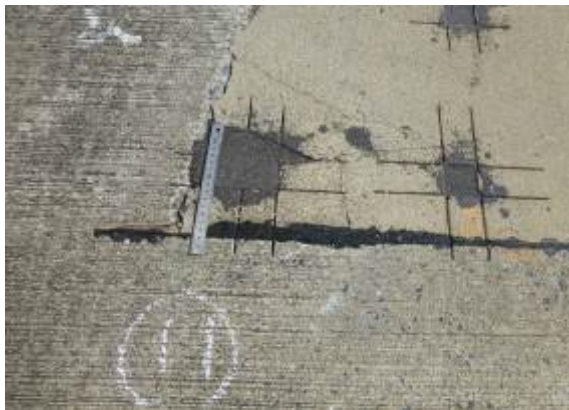
写真-4.2.11 目地材の破損状況
