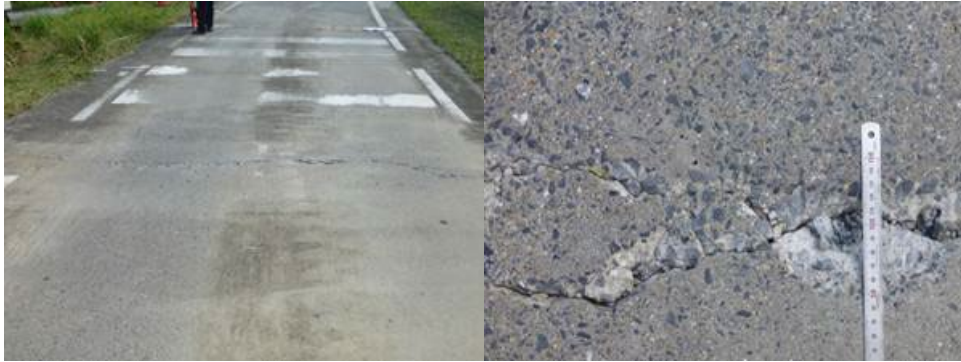
写真-4.2.5 ひび割れ発生状況（工区 0731-1）
