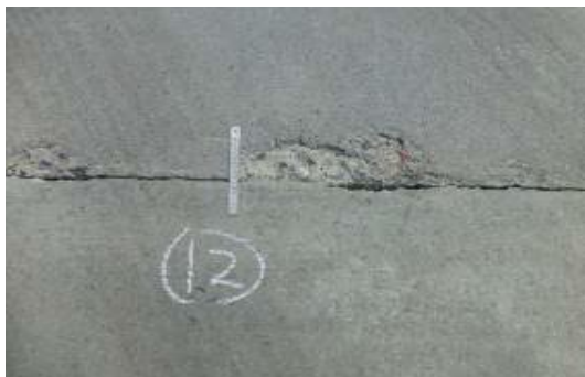
写真-4.2.9 角欠け状況(工区1502)
