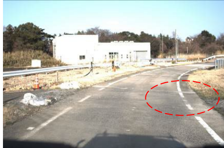
写真-4.2.12 舗装版の段差発生位置
