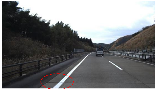
写真-5.2.1 検証箇所（隅角クラック）
