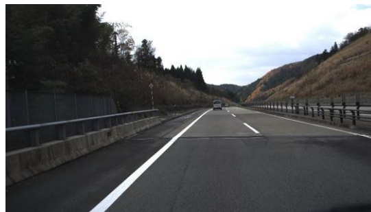
写真-5.2.4 検証箇所（舗装版の段差）
