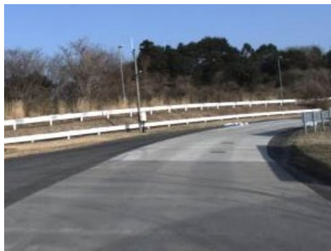
写真-4.2.6 ひび割れ発生箇所（工区 1502）
