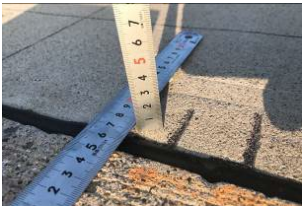
写真-4.2.13 舗装版の段差発生状況
