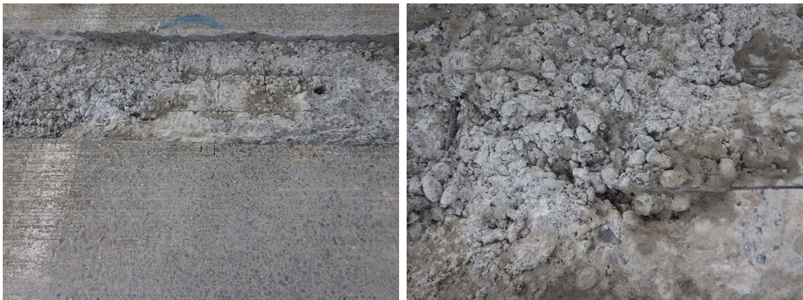
写真-4.3.1 目視で確認された補修面の空隙部
