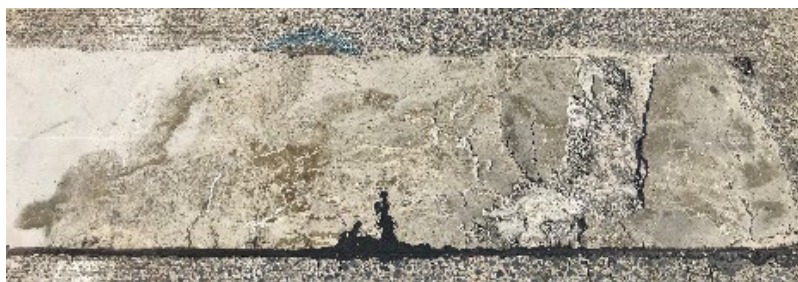
写真-4.3.8 PCM/エポキシ接着剤工区の35万輪走行時の路面状況
