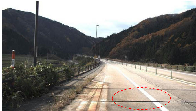
写真-5.2.3 検証箇所（目地材のはみ出し）
