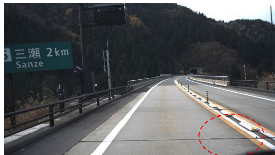
写真-5.2.2 検証箇所（角欠け）
