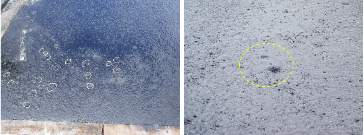
写真-4.5.21 施工中に発生したブリスタリング
