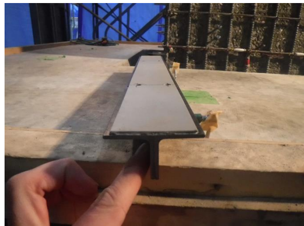
写真-4.4.33 No.2 目地材の端部の形状
