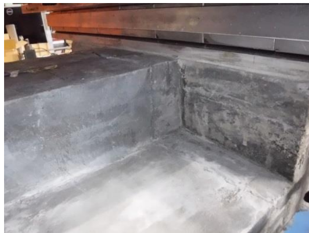
写真-4.4.5 等曲げ区間の圧縮縁の状況 (STEP4)
