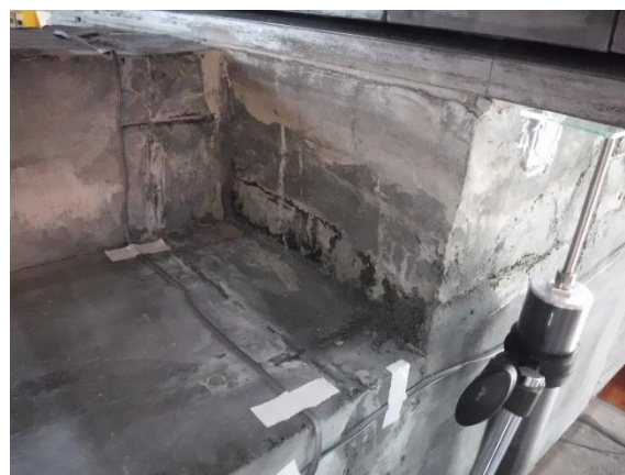
写真-4.4.14 荷版付近の状況
