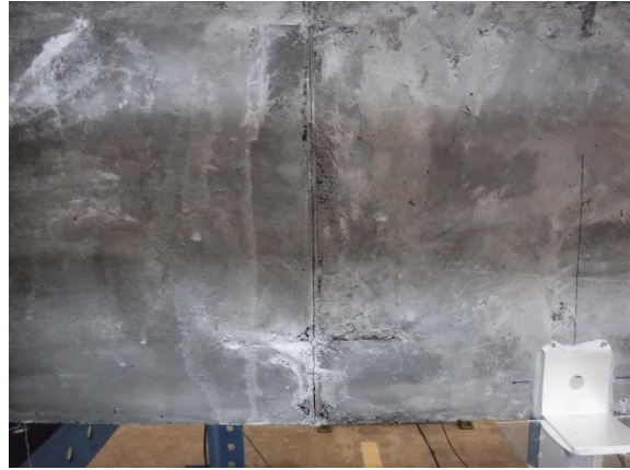
写真-4.4.21 等曲げ区間 下面側目地周辺状況
