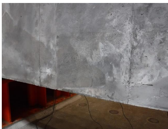
写真-4.4.17 等曲げ区間下面側の目地周辺状況 (目地以外に曲げひび割れは未確認)
