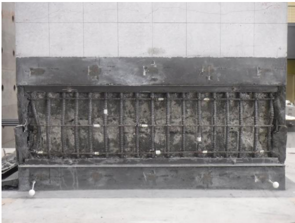
写真-4.4.85 実験終了後 正載荷圧縮側
