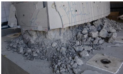
(d) Case-3 (PHb+CF パネル補強) CF パネル除去時の内部コンクリート
