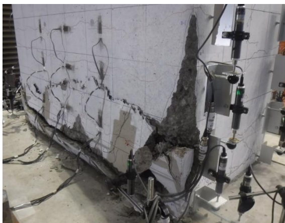
写真-4.4.41 -8\delta_y 3 回目 圧縮側柱基部
