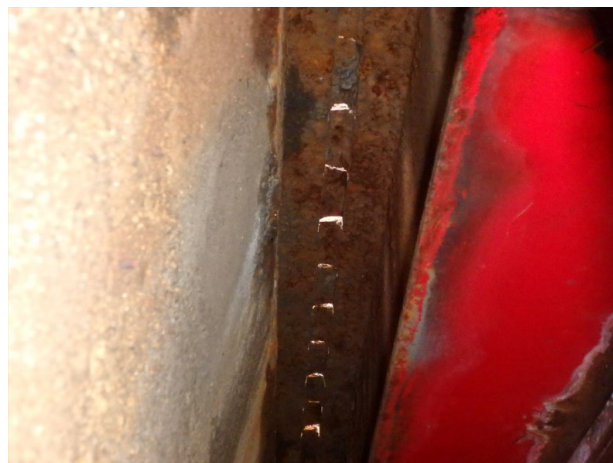
(b) 下方から見上げて撮影。樋がない。櫛歯の下面が腐食している。
