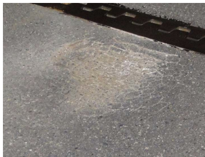
1) 舗装のひび割れ
