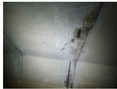
2) 凍結防止剤による塩害（継手部からの漏水）
