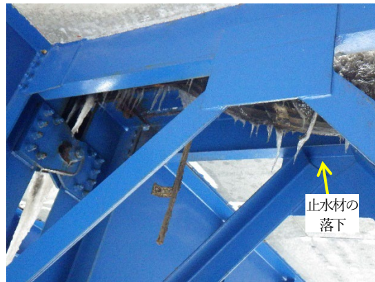
図 3-12-20 伸縮装置の止水材の落下と漏水、つらら (後付けの止水材が部分的に外れて、垂れ下がっていた 30) )
