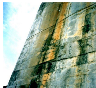
3) 初期内在塩による塩害 (橋脚柱部)
