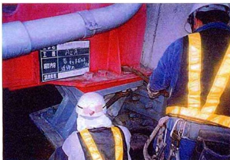
図 3-11-6 緩んだセットボルトの増し締め事例 26)
