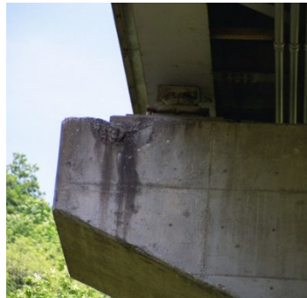
2) 凍結防止剤による塩害 (橋脚梁部)
