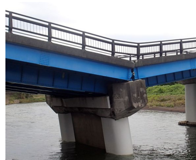
3) ケーソン基礎の洗掘
