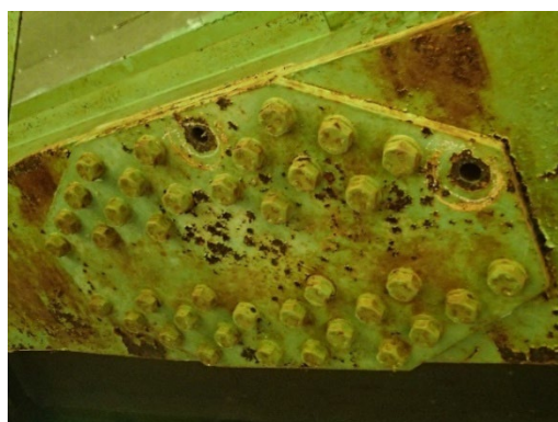
1) ボルトの遅れ破壊が生じた添接部
