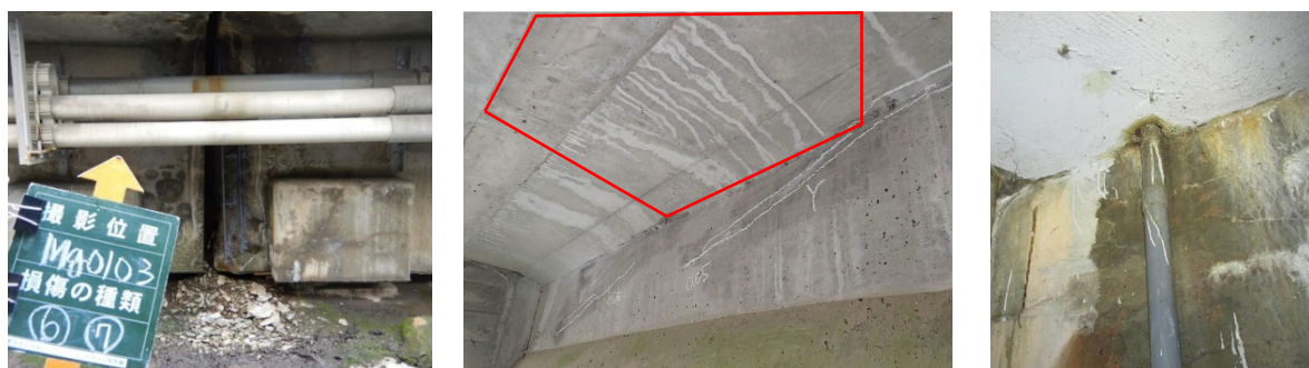
1) 伸縮装置の排水工不良
