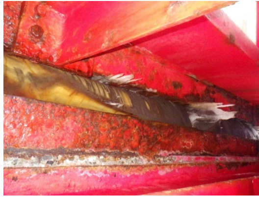
図 3-12-19 伸縮装置の下面に設置された止水材やそのバックアップ材の隙間からの漏水
