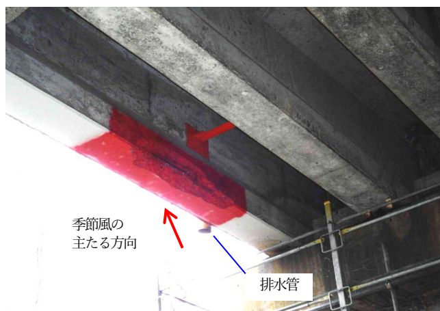
図 3-13-2 季節風により排水が主桁にかかり腐食した事例 56)
