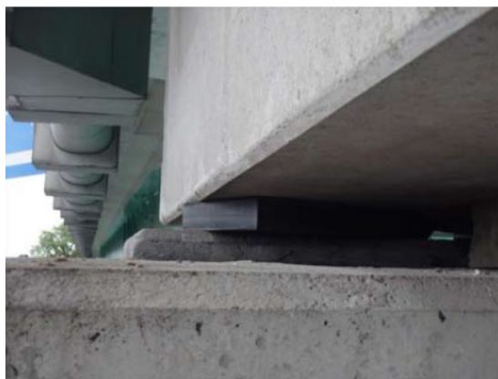
図3-11-7 パッド型ゴム支承のズレ・逸脱の事例
