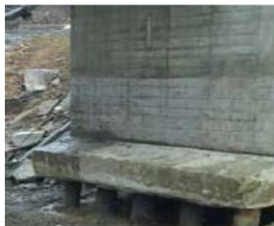
2) 杭基礎の洗掘
