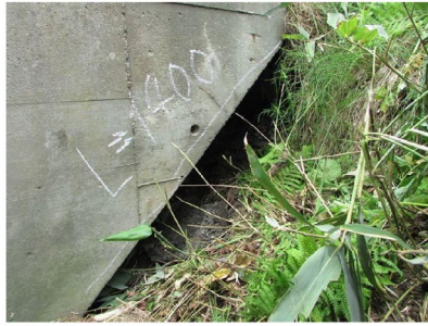
1) 翼壁部の浸食
