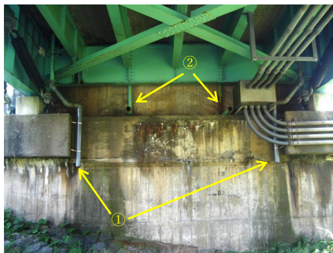
図 3-13-3 流末処理と下部構造の劣化 59)
