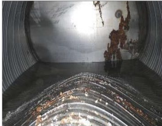
図 3-3-8 ポステン中空床版橋の滞水による変状の例 2)
