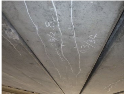
図 3-3-4 ASR による変状例 (PC 鋼材または鉄筋に沿ったひび割れ)
