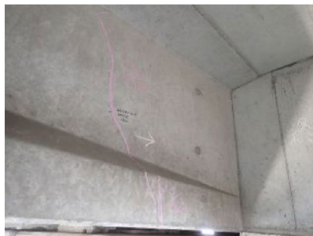
図 3-4-4 連結桁の変状例
