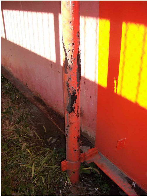
a) 排水管内部からの腐食
