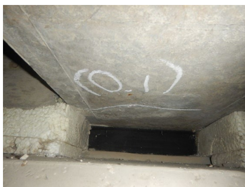
図 3-3-7 連結桁の変状例
