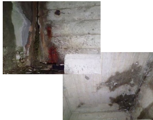
2) 凍結防止剤による変状
