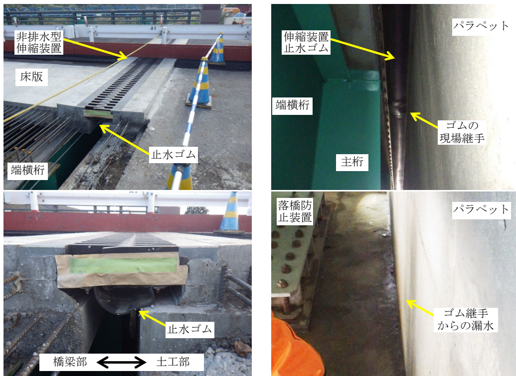
伸縮装置取換えの施工途中 非排水型の止水ゴムの位置 (上：片側交通規制中の路面，下：止水材の断面) 伸縮装置取換え時の止水ゴム現場継手 からの漏水，取換えから1年後 (上：伸縮装置下面，下：橋台上)
