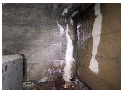
1) 伸縮装置の排水工不良
