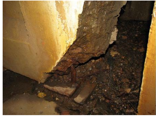
2) 凍結防止剤による変状
