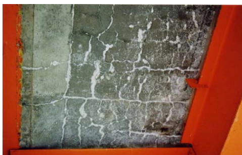
1) 床版下面の格子状のひび割れ
