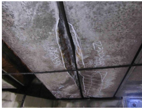
図3-3-11 防水・排水工不良による変状例
