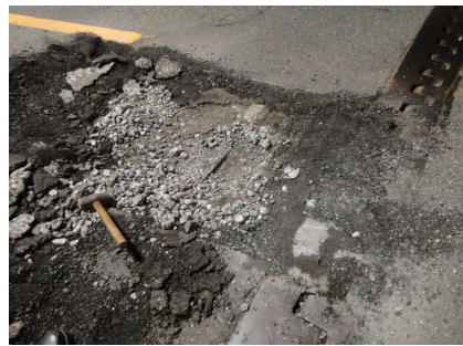
2) 床版コンクリート上面の土砂化
