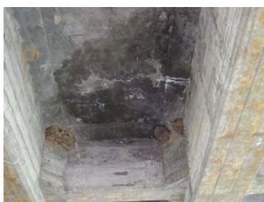
2) 床版防水工未設置
