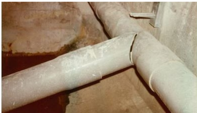
図 3-13-8 箱桁内部の排水管と継手部の損傷例 55)、56)
