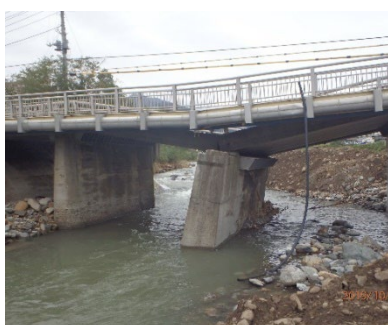
1) 直接基礎の洗掘
