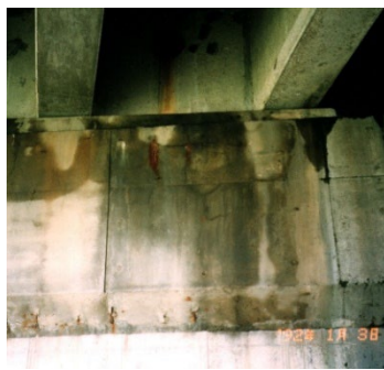
1) 飛来塩による塩害 (橋台堅壁前面)
