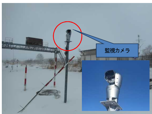
写真-30 監視カメラ設置状況
