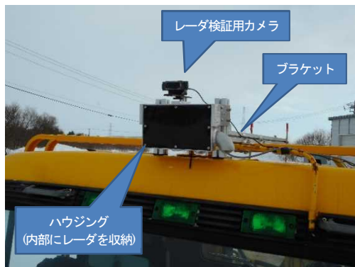
写真-40 ミリ波レーダ設置状況
