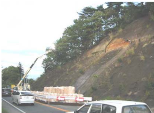
(a) 被災箇所の状況 (再掲)
