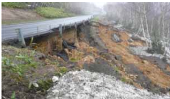
写真-1 融雪期に発生した道路盛土変状事例
