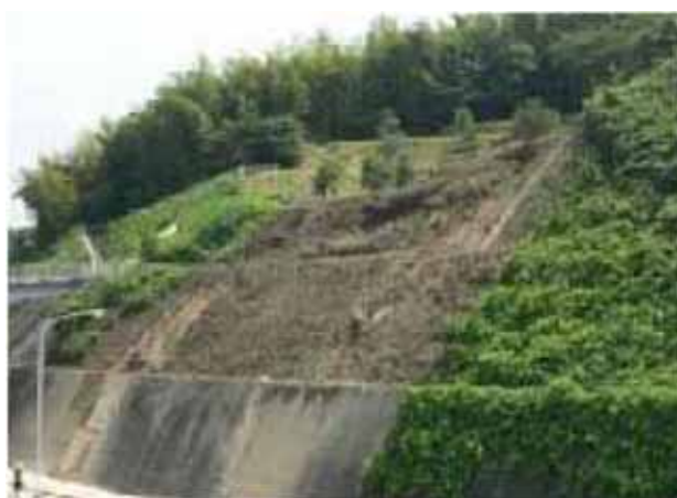
写真 2-12 背後地からの表流水による崩壊事例
