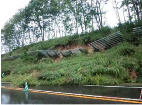
(a) 被災箇所状況
