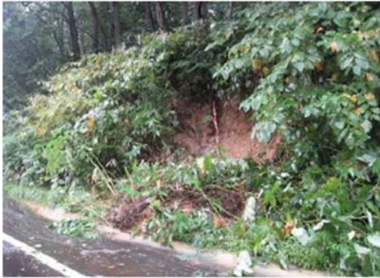
(a) 被災箇所状況
