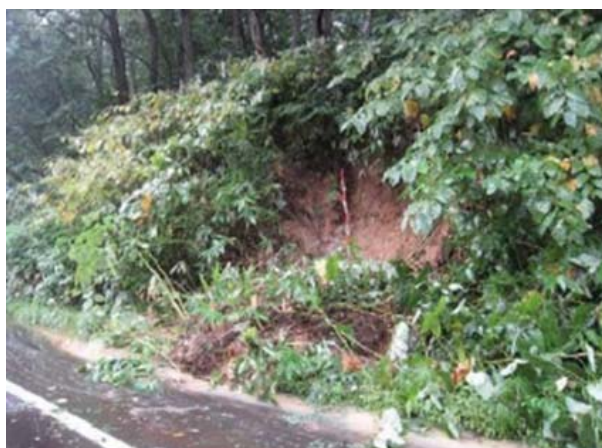
(a) 被災箇所の状況 (再掲)
