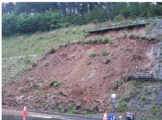
(a) 被災箇所状況
