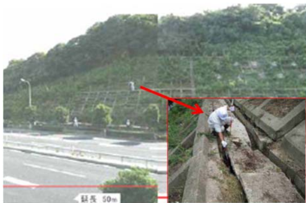
(a) 被災箇所状況
