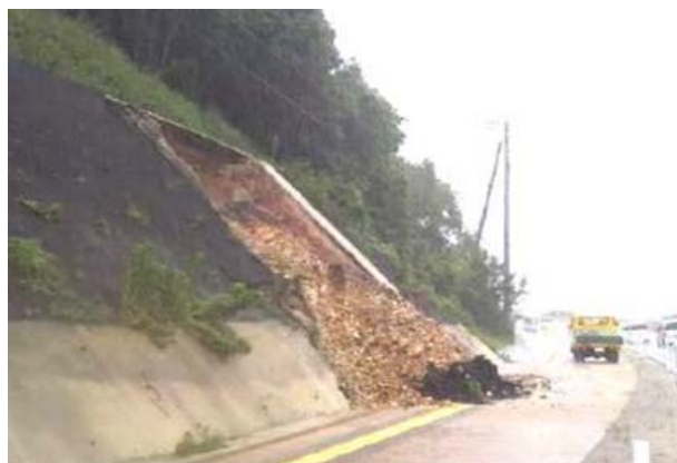
(a) 被災箇所状況 (再掲)
