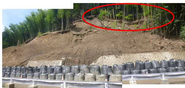
写真-3 集水地形直下の表層崩壊の事例 崩壊斜面の上方に集水地形（赤丸内）が存在する。
