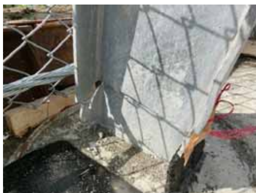
(a) 孔有り：吊り線用の孔からの亀裂
