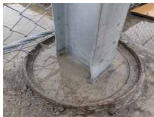
(b) 孔無し：亀裂の発生なし
