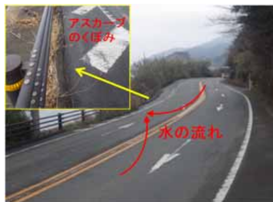
写真2-5 アスカープ箇所(滞水 オーバーフロー)
