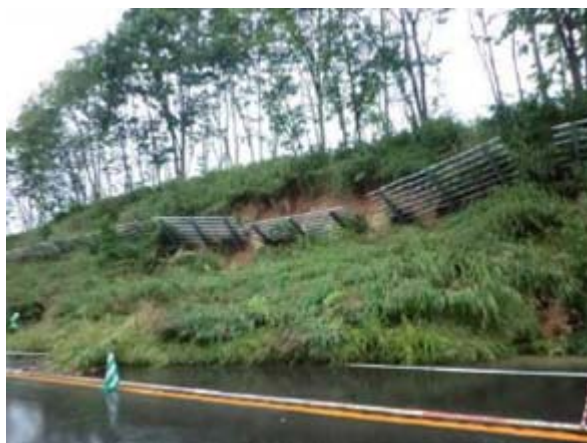
(a) 被災箇所状況 (再掲)
