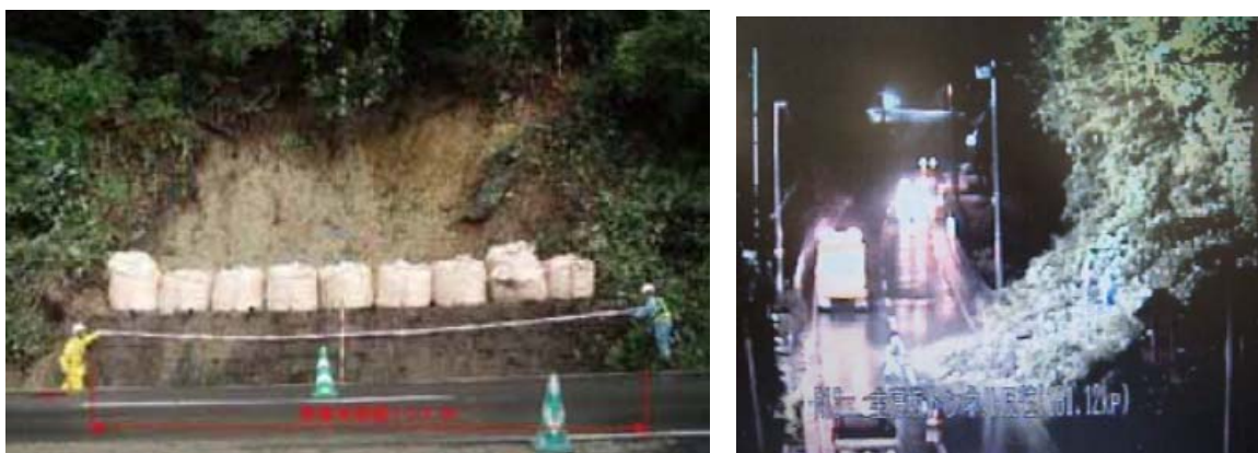
(a) 被災箇所の状況
