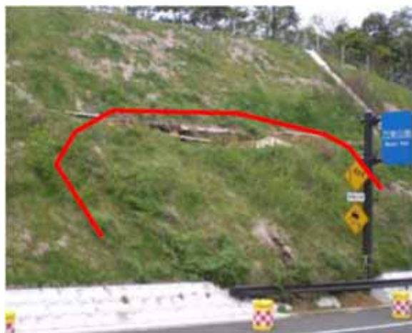
写真 2-11 谷部の切土箇所の事例（脆弱部残存）
