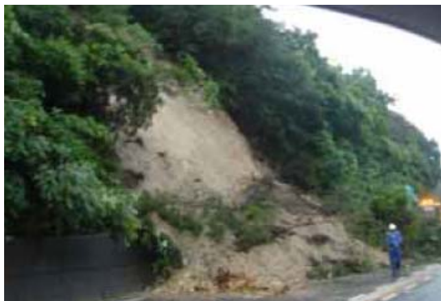
(a) 被災箇所状況
