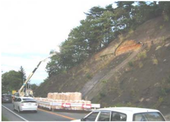
(a) 被災箇所状況
