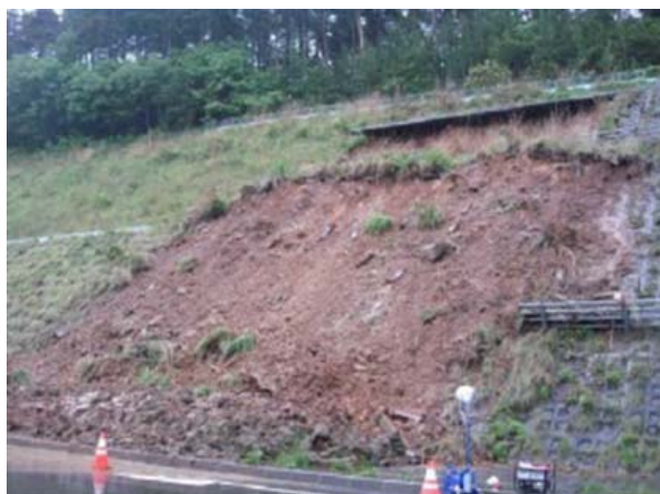
(a) 被災箇所状況 (再掲)
