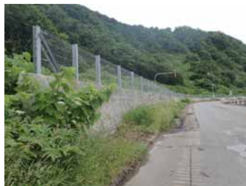
写真-1 従来型落石防護柵
