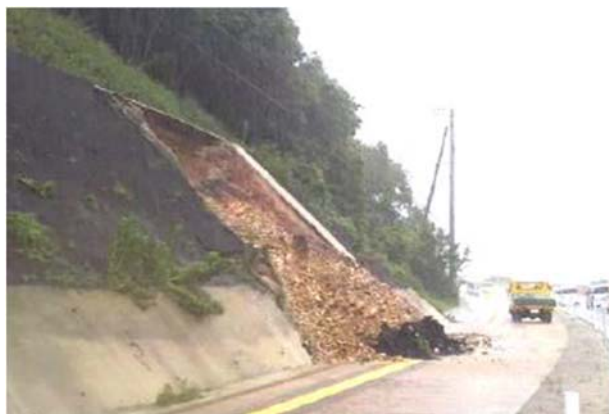
(a) 被災箇所状況
