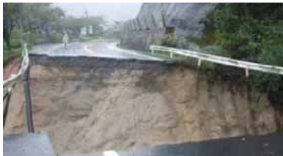
(a) 崩壊状況
