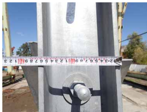
(b) 補強有り：ウェブ部の陥没なし
