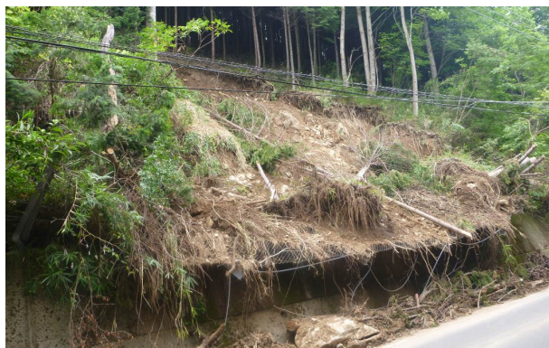
写真-1 表層崩壊の事例
