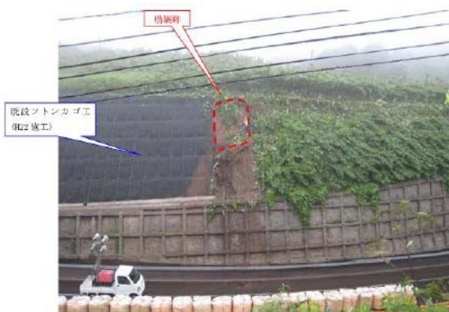
(a) 被災箇所の状況 (再掲)
