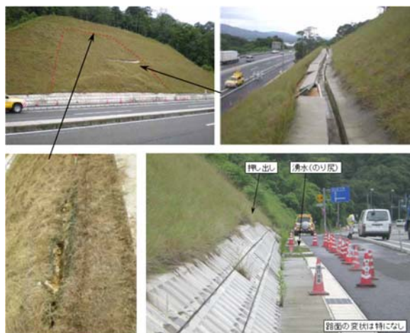
(a) 被災箇所状況
