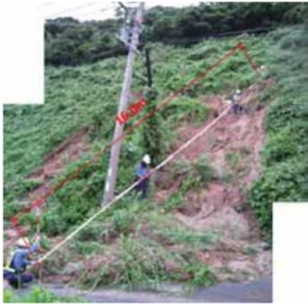
(a) 被災箇所状況
