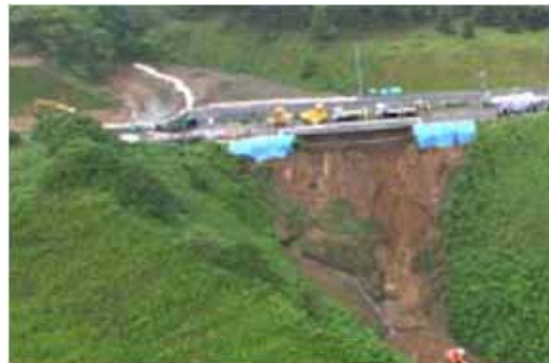
(a) 崩壊状況
