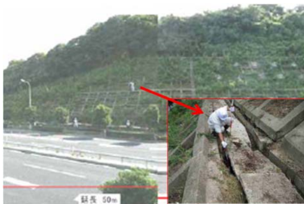
(a) 被災箇所状況 (再掲)
