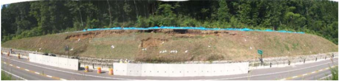
(a) 被災箇所状況
