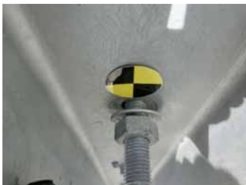
(a) 補強無し：ウェブ部のナットによる陥没
