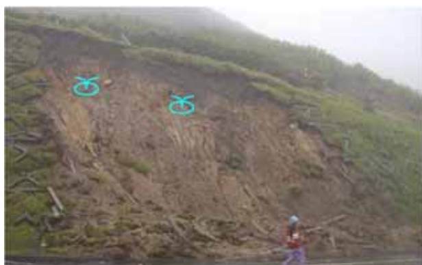
(a) 被災状況
