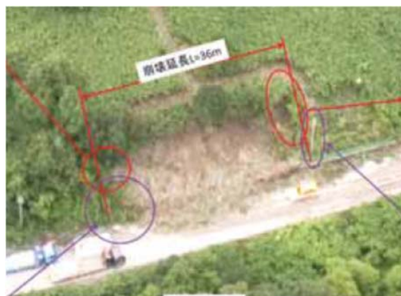
(a) 被災箇所状況 (再掲)
