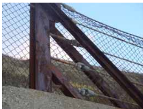
写真-3 防護柵の支柱の腐食
