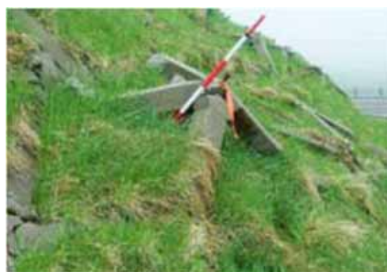
(b) 凍上による浮き上がり
