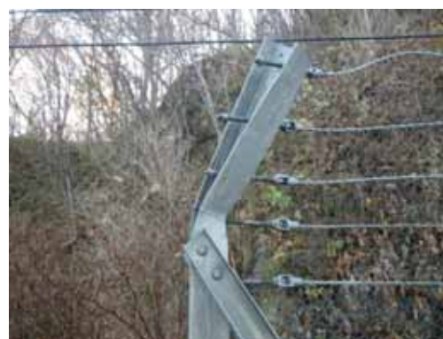
写真-4 防護柵の支柱の変形
