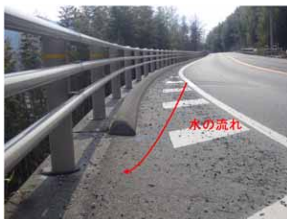
写真2-6 アスカープ箇所(端部流入)
