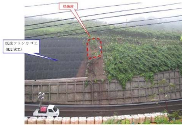
(a) 被災箇所状況
