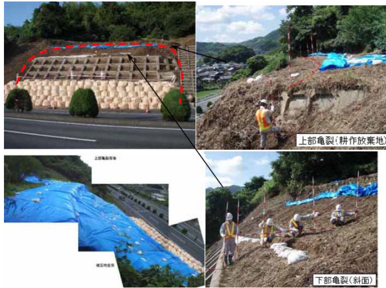
(a) 被災箇所の状況
