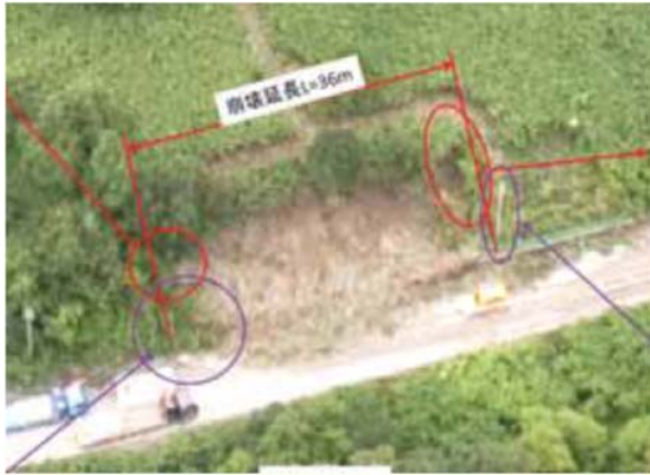
(a) 被災箇所の状況
