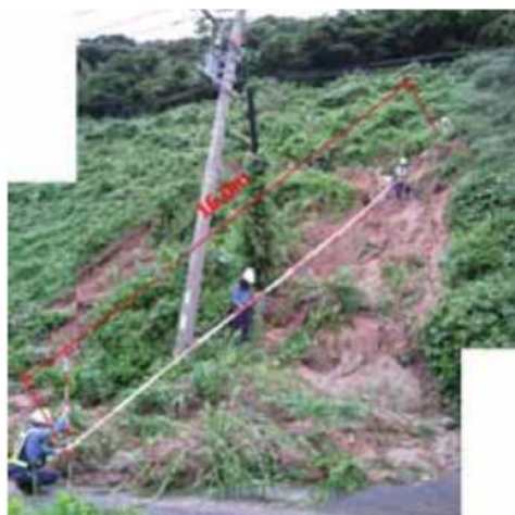
(a) 被災箇所の状況 (再掲)
