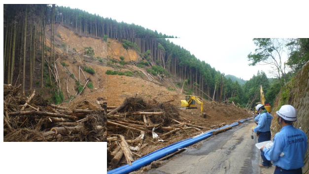
写真-4 厚い風化層の深層崩壊の事例
