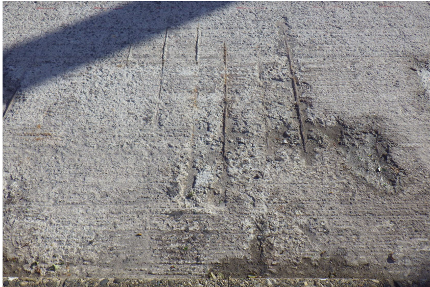
図-3.4.5 かぶり不足や切削による床版上面の鉄筋露出の例 6)
