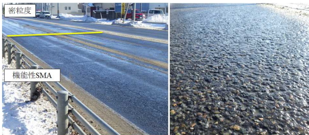
写真-3 供用後19年経過した機能性SMA
