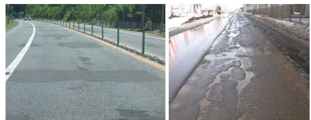
写真-1 排水性舗装の破損状況
