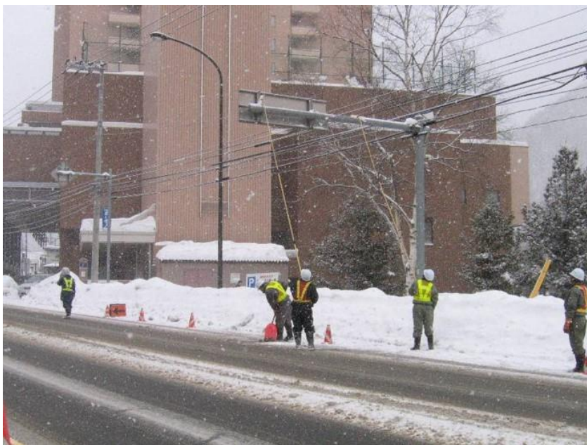
図1 道路案内標識への着雪と着雪除去作業の様子
