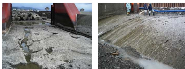
図-4 S 頭首工および Y 頭首工の可動堰・エプロンの状況
