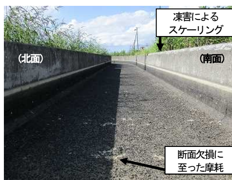
図-47 コンクリート開水路の摩耗と凍害
