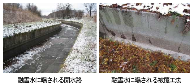
図-33 積雪寒冷地に位置するコンクリート開水路の非灌漑期の状況
