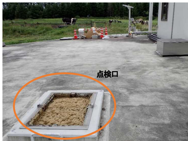
図-34 消泡機が設置されていない開口部（点検口） （調査対象施設近隣の肥培灌漑施設）
