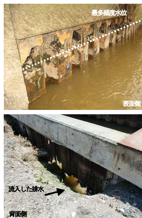
図-12 鋼矢板の腐食の代表的な現況
