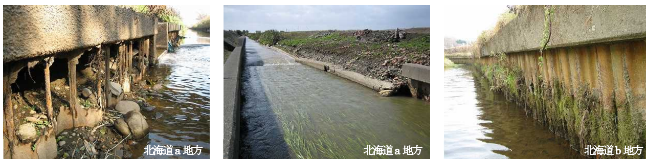
図-10 北海道内における農業用排水路を構成する鋼矢板の腐食
