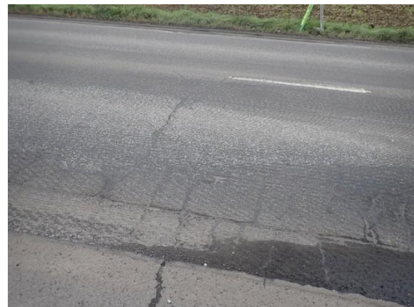
写真-2.2.2 一般国道 276 号倶知安町の切削後の路面状況
