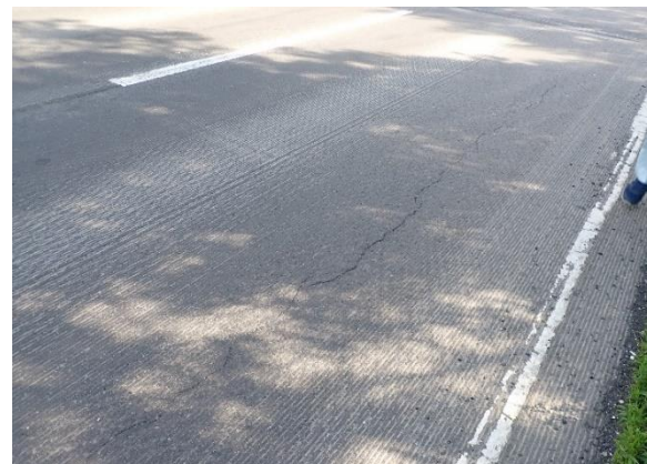
写真-2.2.1 一般国道 44 号厚岸町の切削後の路面状況
