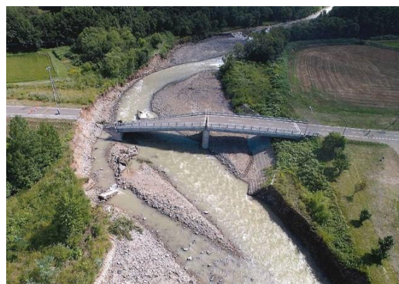
河岸侵食に伴う落橋
