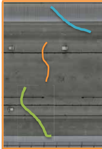
図 4-14 ひび割れ検出結果
