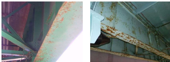
(a) 下フランジ下面 (b) 腹板および下フランジ 図-23 a-1 塗装系で見られた典型的な劣化事例
