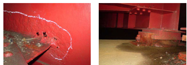
図-22 Rc-III 塗装系で見られた典型的な早期劣化事例
