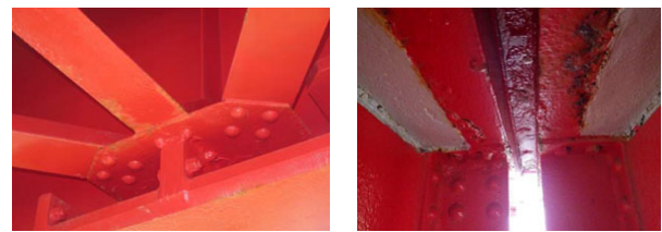
図-21 Rc- I 塗装系で見られた典型的な早期劣化事例
