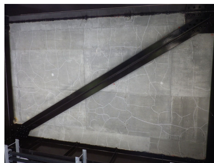
(b) 表層のひび割れと見られる事例 (M橋) 写真-2 パターンの異なる二方向ひび割れ
