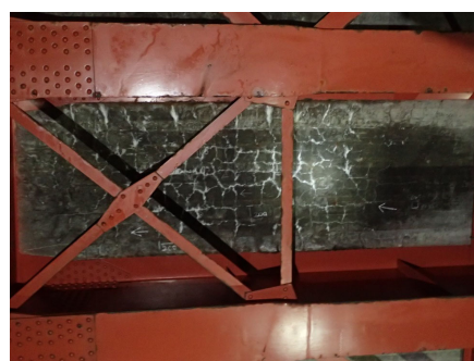
(a) 疲労によるひび割れと見られる事例 (E橋)
