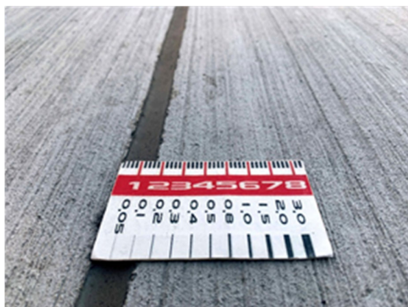
写真-4.17 施工後2ヶ月目の目地の状況
