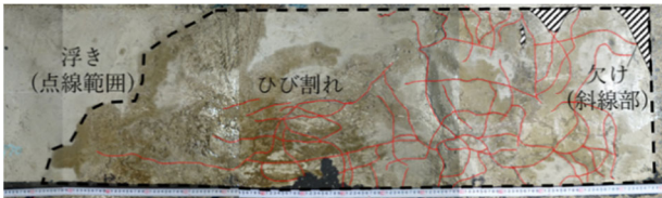
写真-4.3 破損状況（早期に破損した事例）
