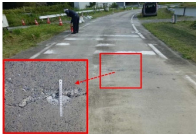
写真-3.6 横断ひび割れ発生箇所の写真
