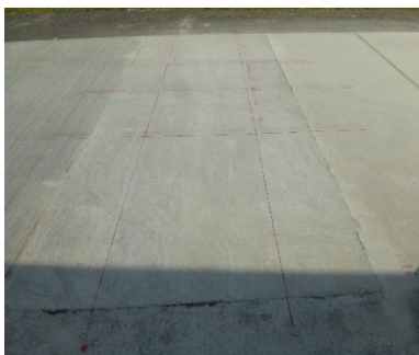
写真-4.4 35万輪走行後の状況（施工箇所③）
