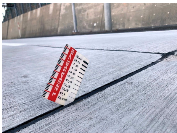
写真-4.14 施工後2ヶ月目の目地の状況
