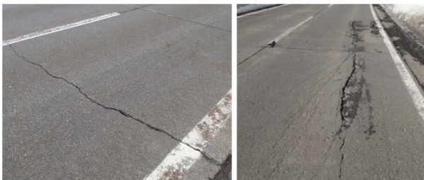
写真-3.8 凍上の影響と推察される縦断・横断ひび割れ (構造的損傷)
