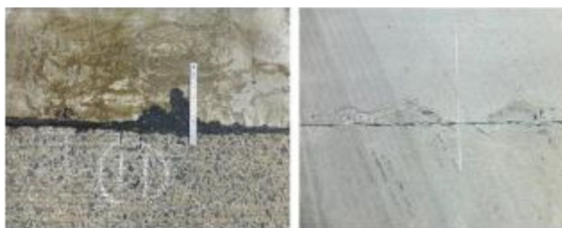
写真-3.5 損傷写真(左:目地のはみ出し、右:角欠け)
