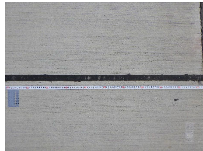
写真-4.5 35万輪走行後の状況（施工箇所②）
