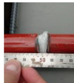
写真-3.4 バーの破断
