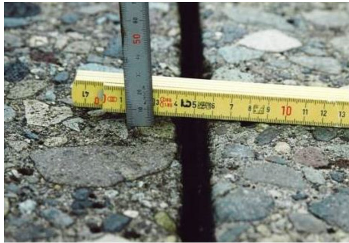
写真-2.1.3 発生した段差 2)
