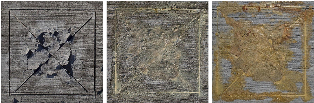
写真-4.4.5 模擬亀甲ひび割れ箇所の外観変状（けい砂有り） （撮影位置⑤）：左：補修前 中：補修直後 右：35万輪後
