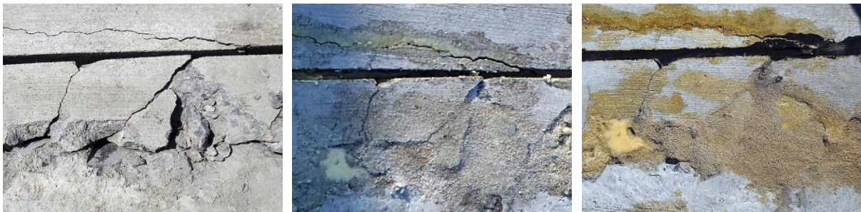
写真-4. 4. 1 模擬隅角ひび割れ箇所の外観変状
