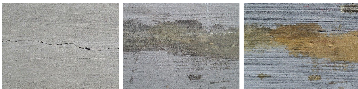
写真-4.4.3 模擬横断ひび割れ箇所の外観変状
