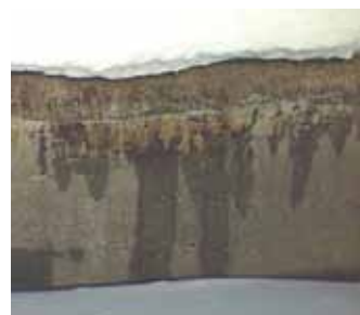
埋設区間左岸（南西面） 凍害ひび割れ箇所からの浸み出し (2010年3月24日, 15:00)
