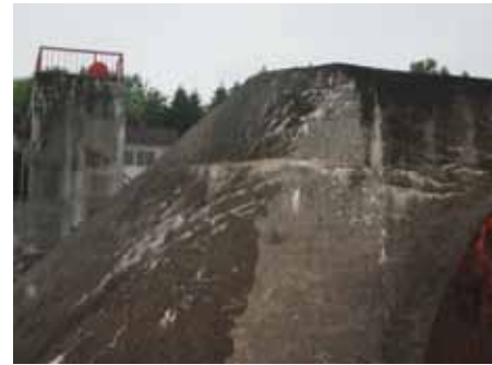
写真-3.1 頭首工堰柱部のひび割れ
