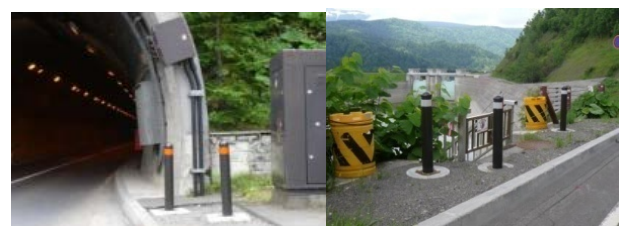
図-3.12 衝撃吸収型ボラードの設置状況
