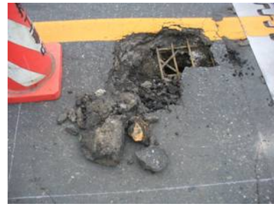
写真-5.2 陥没が生じたRC床版
