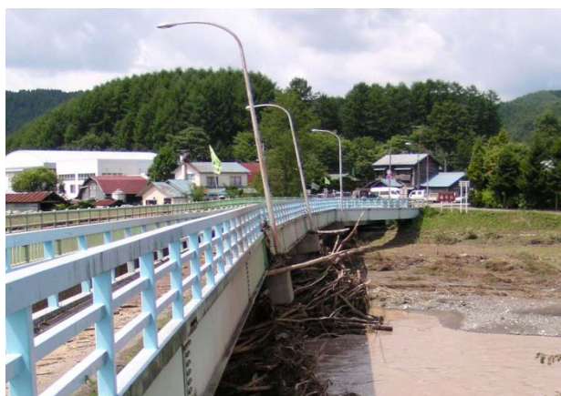
図-6.2 2003年8月沙流川出水時における額平川貫気別橋
