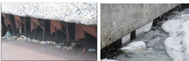
図-3. 29 オホーツク海に面した鋼平板の流水による劣化例
