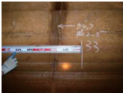
図-11.14 函体に生じたクラックの一例（スパン3）
