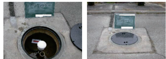
(a) マンホール内の GPS アンテナ
