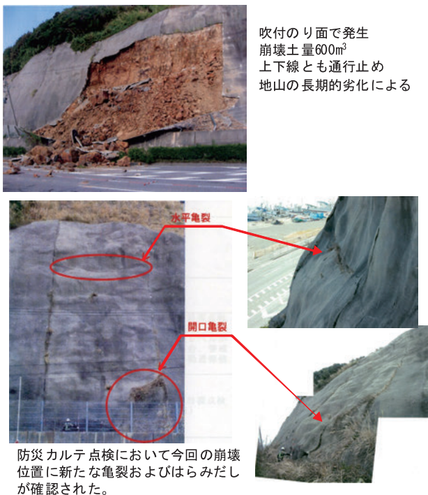
図 3.2.2 岩盤崩壊の災害事例
