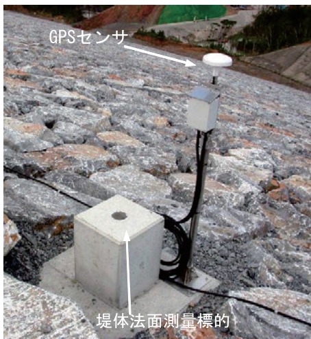
図-8.2 外部可動標的の基礎に設置した GPS センサ
