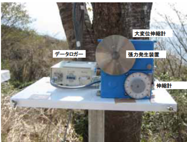
写真 4. 4. 5 大変位伸縮計とデータロガー
