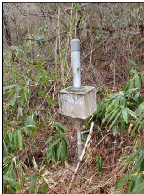
写真 4.12 孔口部の浮上り現象
