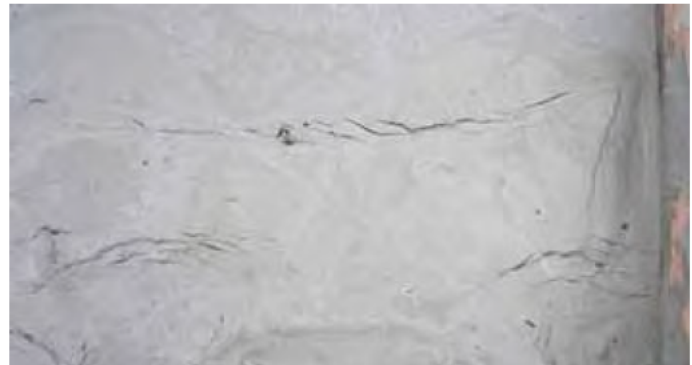
写真 4.11 充填材表面に発生した体積収縮に伴う亀裂(2 日目)
