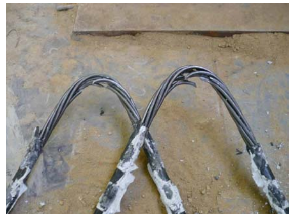
写真-2.25 PC 鋼より線の破断状況
