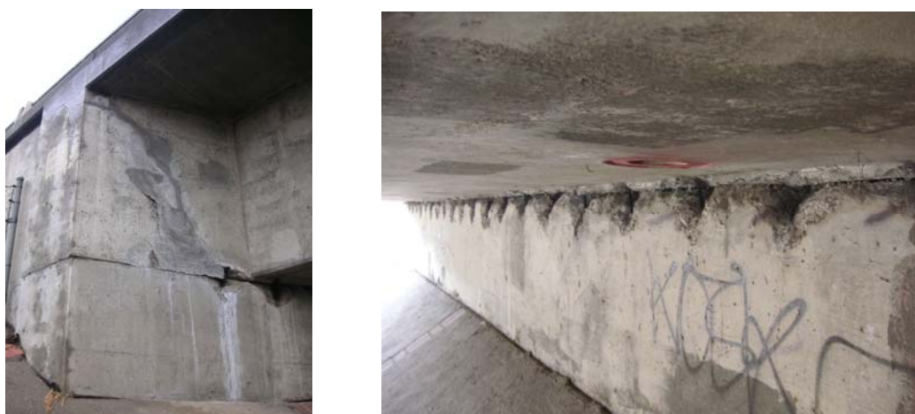
図 1.1.5 斜角を有する橋梁での損傷事例
