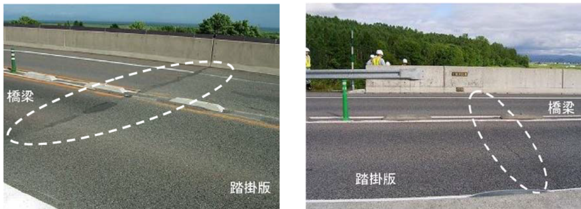
図 1.1.3 橋台背面の舗装のひび割れ状況
