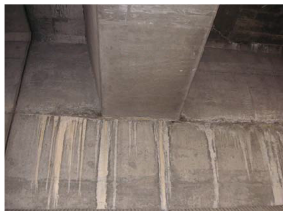
図 3.4.3 コンクリート桁打継目の遊離石灰の析出
