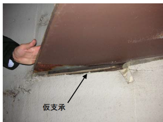
図 3.4.2 鋼桁下面に生じたひび割れ
