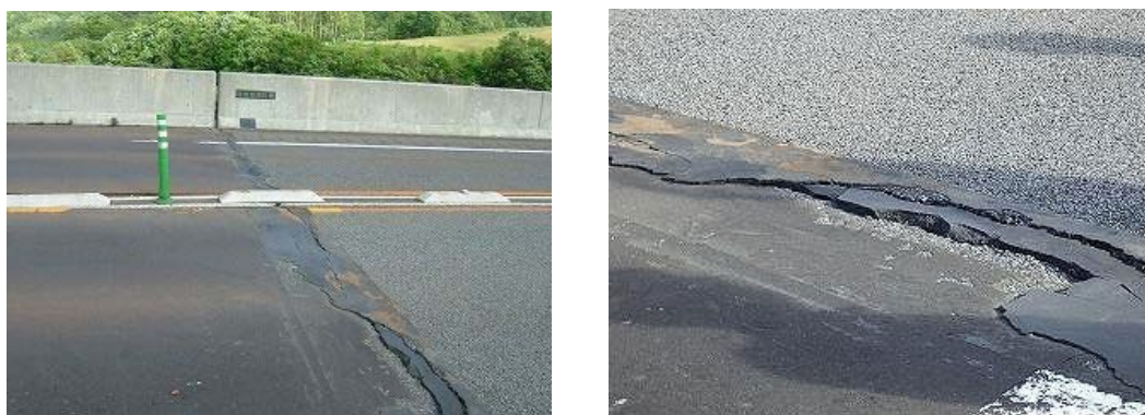
図 1.2.1 橋台背面の舗装の損傷例
