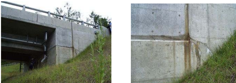
図 2.3.3 上部構造と橋台壁の接合部の損傷
