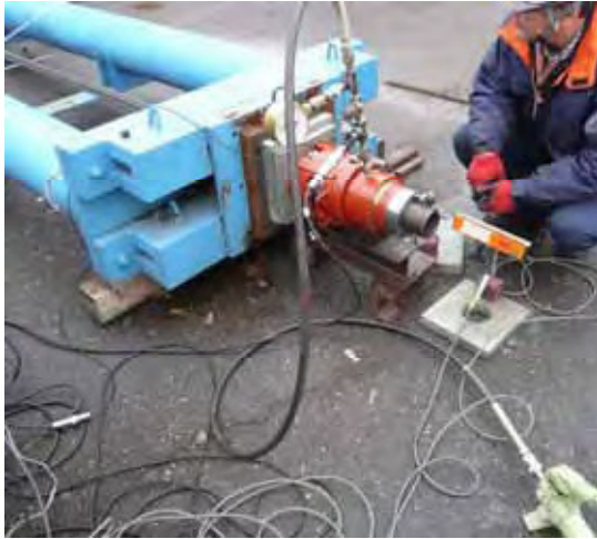
アンカーヘッド（緊張治具取付け）側
