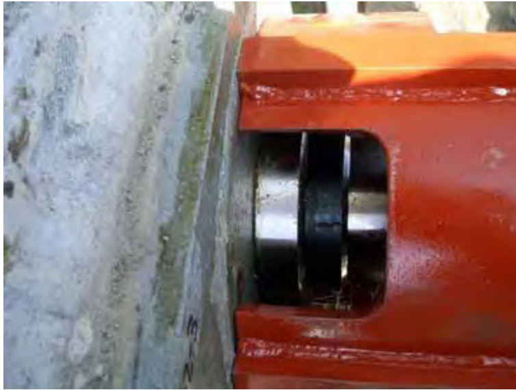
写真 10.30 リフトオフ前 のアンカーヘッド
