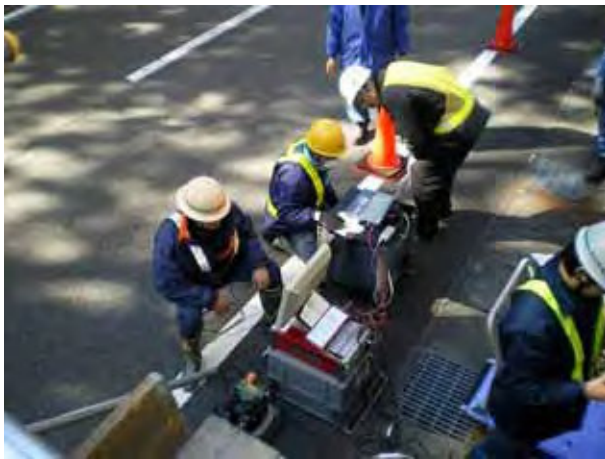
油圧コントロール、計測作業
