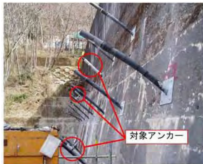
写真 11.17 砂防堰堤でのグラウンドアンカーの軸力測定実施状況 (FBG センサ式荷重計)
