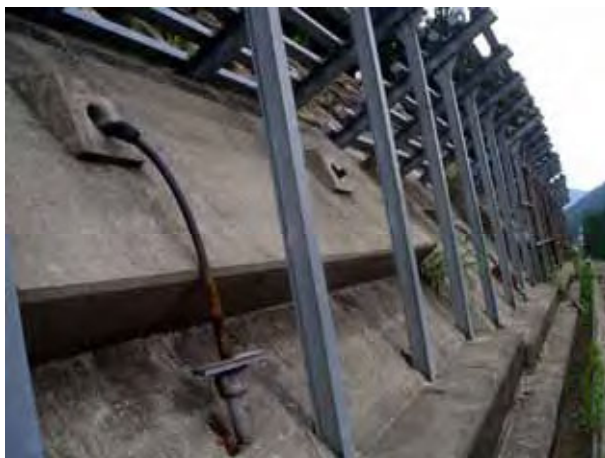
写真 1.1 地すべり滑動によるアンカーの破断事例
