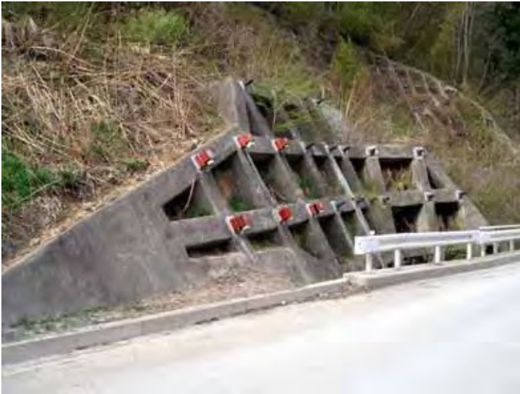
写真 10.22 試験後の法面
