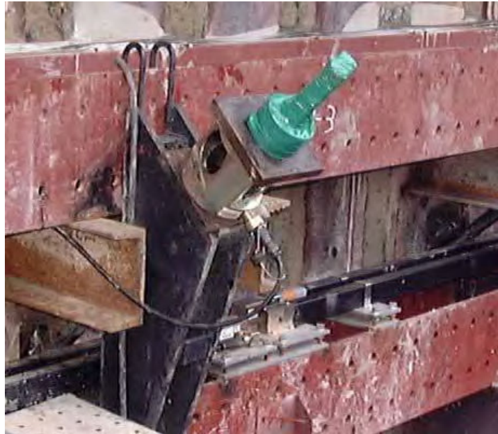
写真 11.12 山留め工事におけるアースアンカーの軸力測定実施状況 (差動トランス式荷重計)
