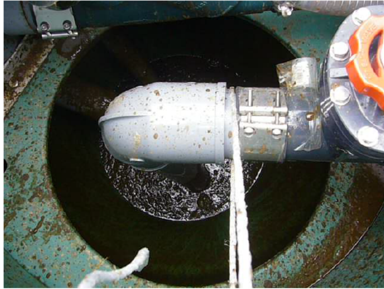
写真4-1-4 吸い込み設備によるふん尿吸い込み状況
