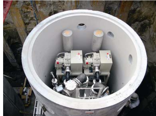
写真2-4 小型真空（CP）ステーション
