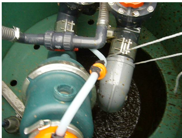
写真4-1-3 真空弁ユニット（真空弁）によるふん尿吸い込み状況
