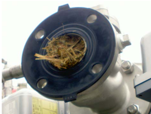
写真4-1-8 チャッキ弁にわらが詰まった状況
