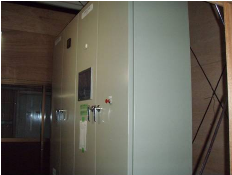
図-3.2.17 動力制御盤外観
