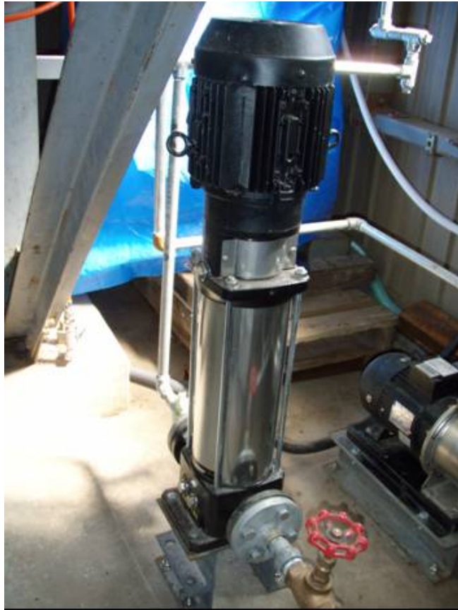
図-3.2.14 冷却水供給ポンプ外観
