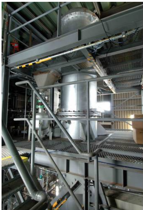
図-3.2.5 流動炉外観
