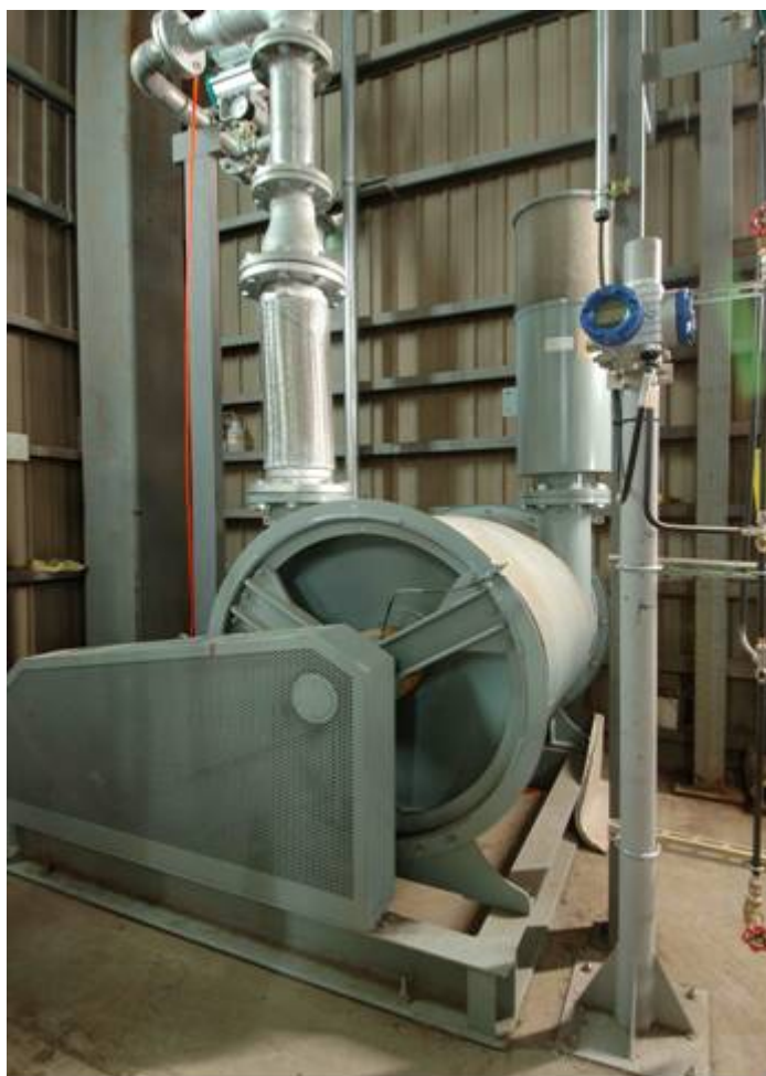
図-3.2.11 起動用ブロワ外観
