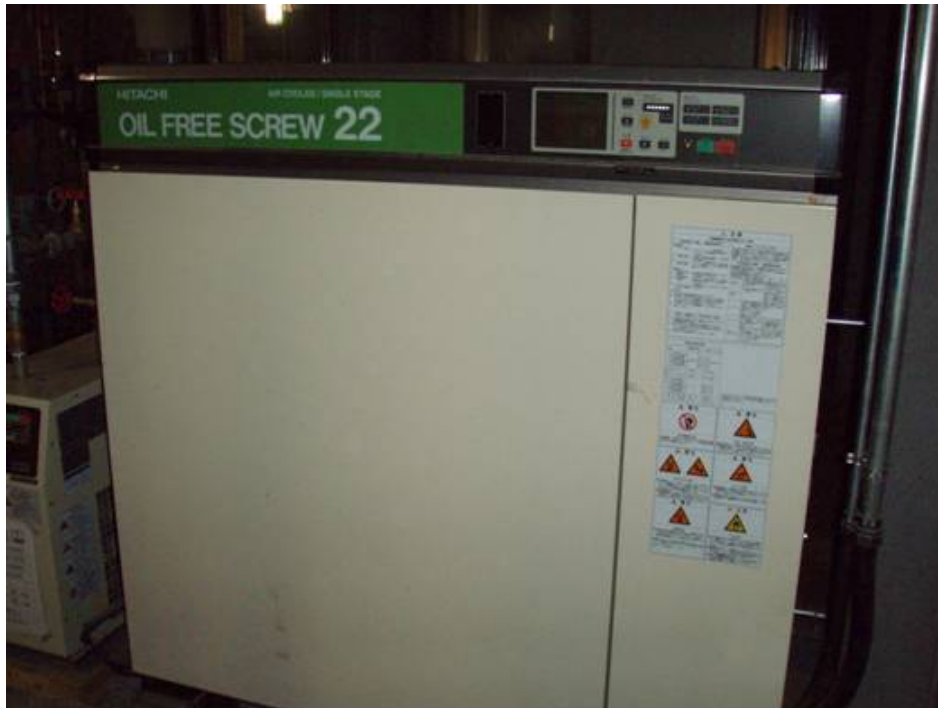
図-3.2.15 コンプレッサー外観
