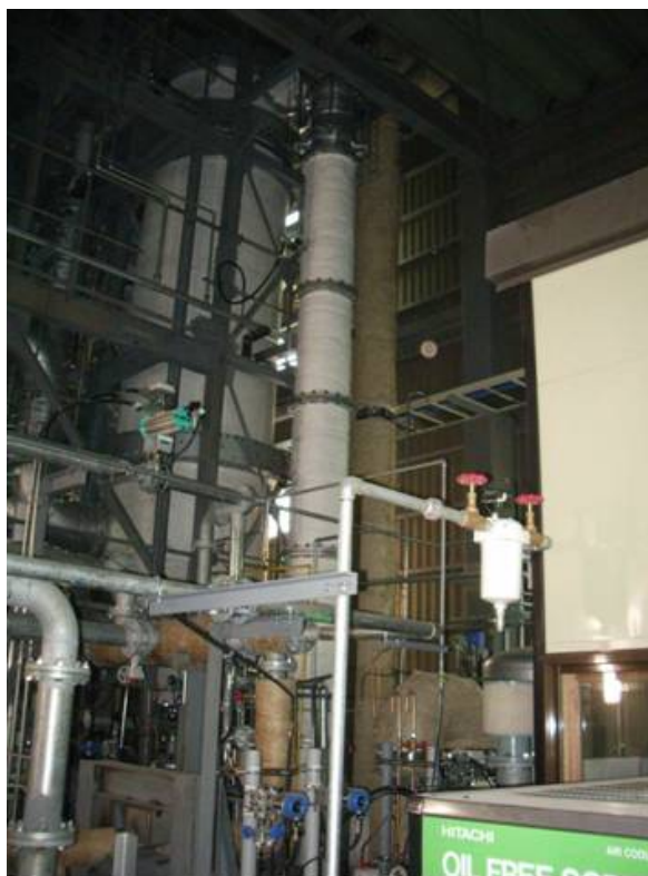
図-3.2.8 集塵機外観
