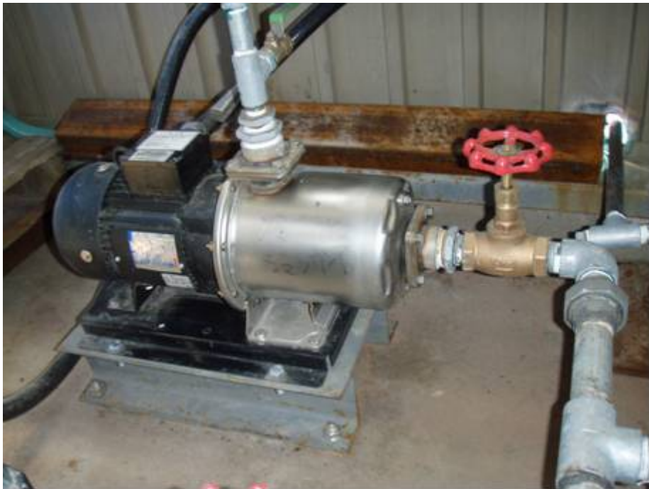
図-3.2.13 冷却水循環ポンプ外観
