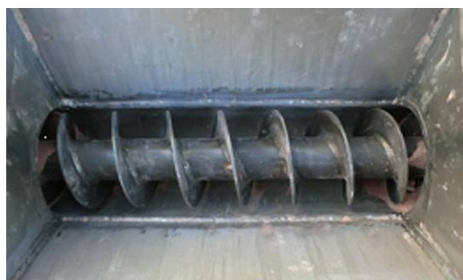
図-3.7.10 集塵機下部 灰排出装置
