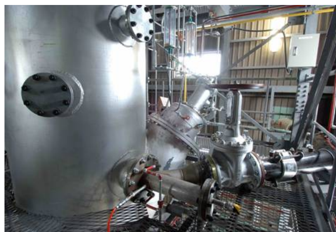
図-3.2.6 汚泥供給口
