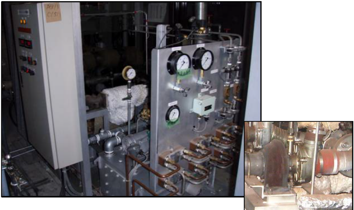
図-3.2.10 過給機ユニット外観と過給機本体
