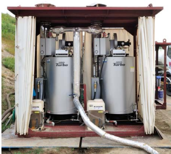
写真-4.3 蒸気ボイラー
