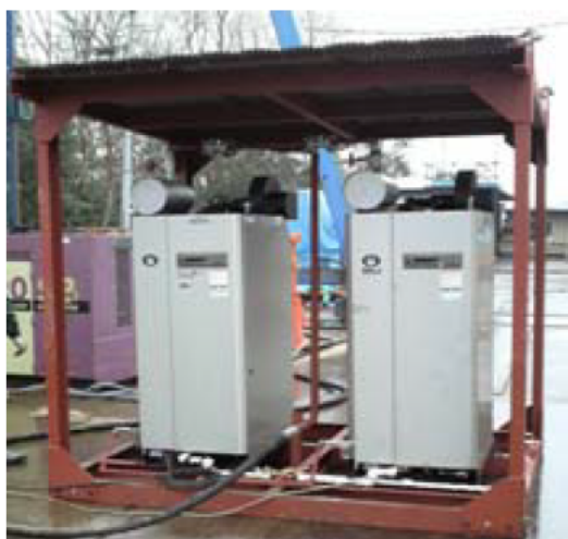
写真-3.3 蒸気ボイラー
