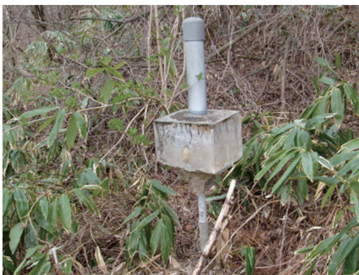
写真-3-1-1-1 孔内傾斜計ガイド管の浮き上がり例
