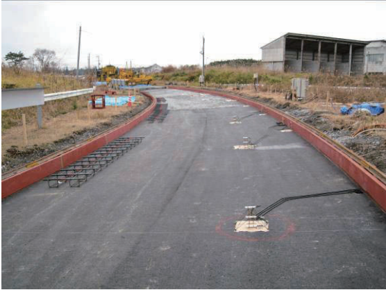
写真-3.24 ひずみ計 (全景)
