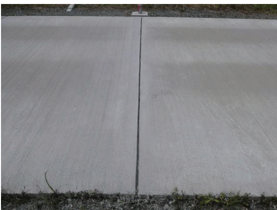
写真-3.40 加工後の誘発ひび割れ部
