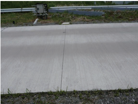
写真-3.38 加工前の誘発ひび割れ部
