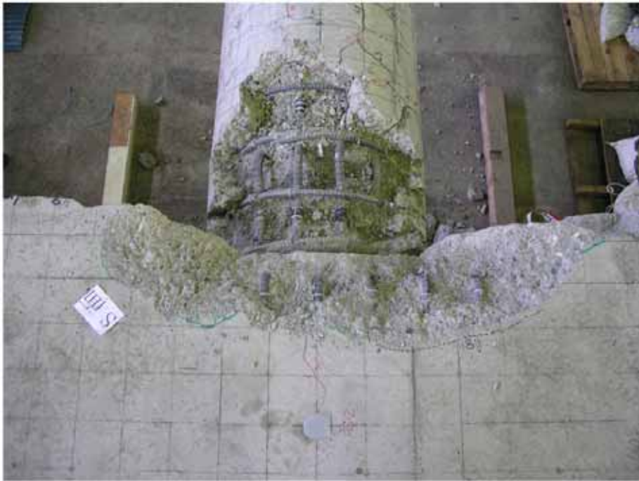
写真-2.5 実験終了後杭体損傷状況 (Case CPP-S-2)
