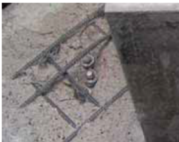
(d) フーチング上面での鉛直押抜きせん断破壊
