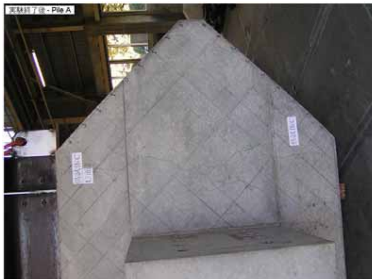
写真-4.23 実験終了後 フーチング上面損傷状況 (Case SPP-C-2, PileA)
