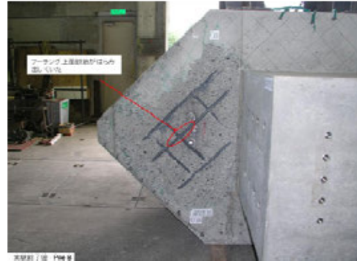
フォーミング上面の損傷状況
