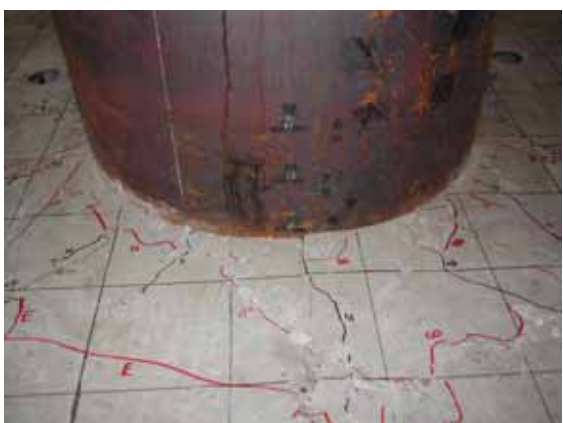
載荷終了後 載荷方向面 (東側=圧縮縁)
