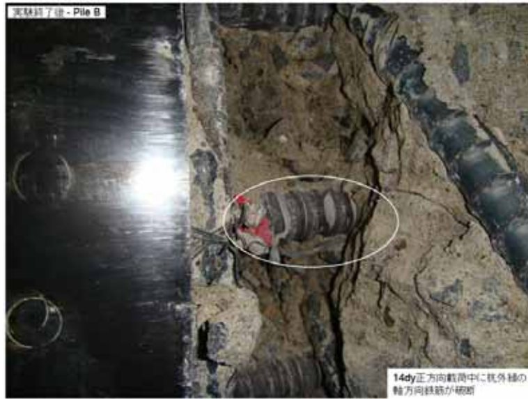
写真-4.22 実験終了後 杭体損傷状況 (Case SPP-C-2, PileB)
