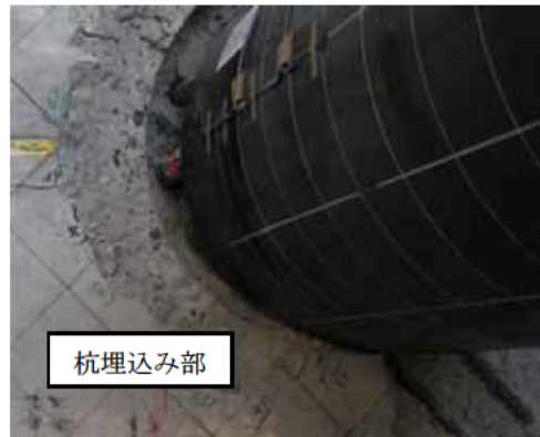
(b) 縁端側から反対位置の損傷
