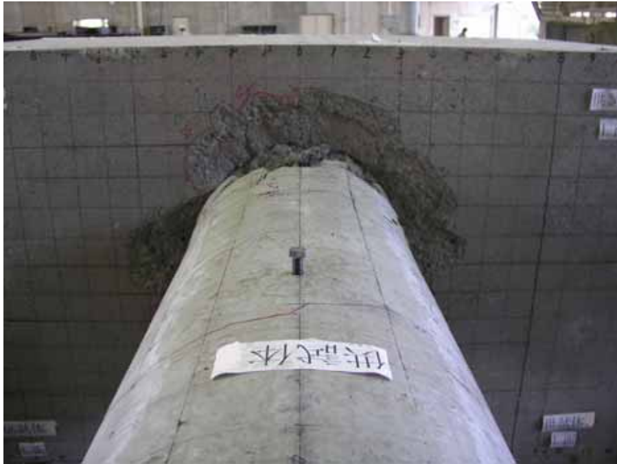
写真-2.2 実験終了後フーチング損傷状況 (Case CPP-S-1)
