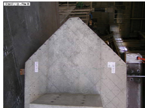
フォーミング上面の損傷状況
