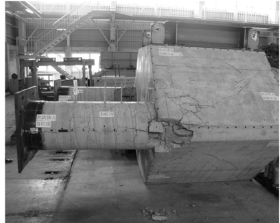
(a) 縁端側の損傷
