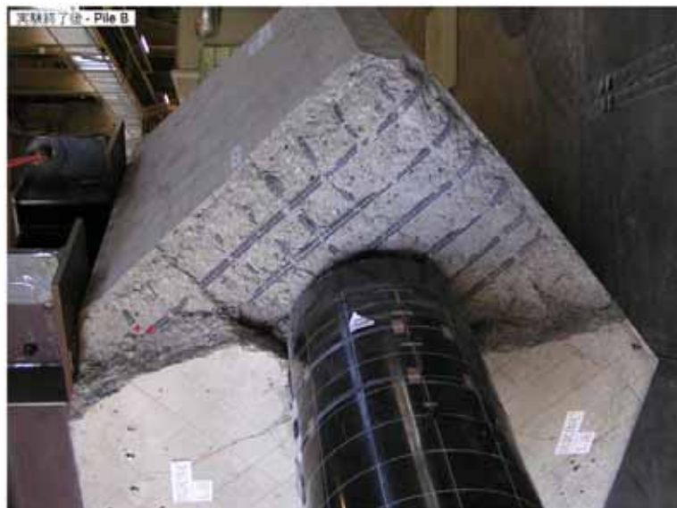
写真-4.20 実験終了後 縁端部損傷状況 (Case SPP-C-2, PileB)
