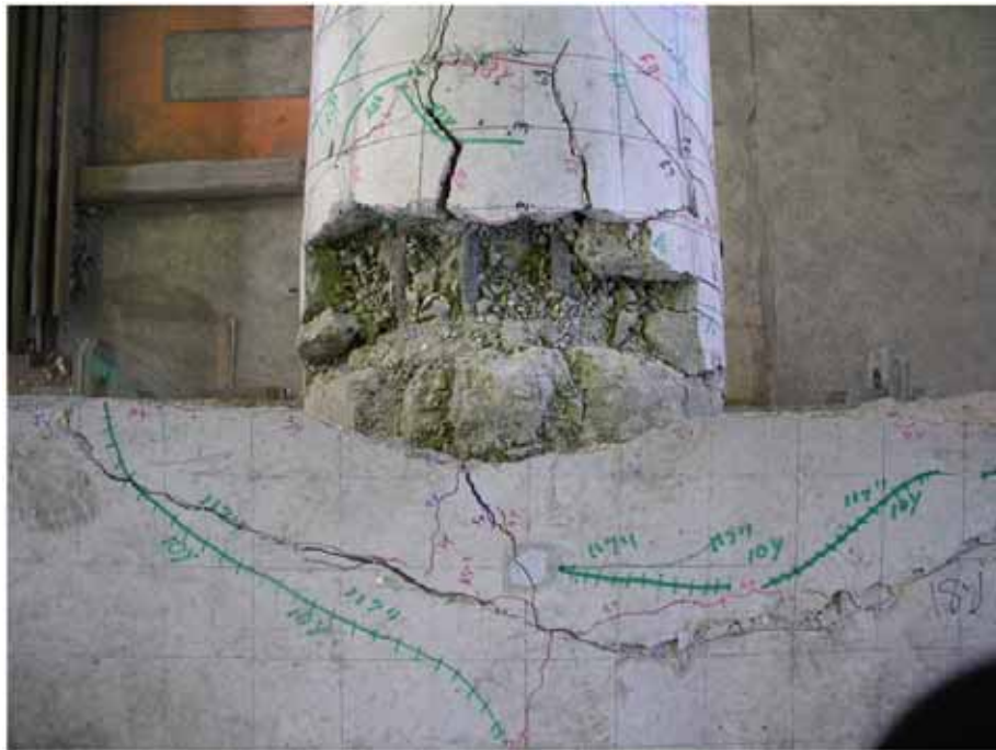
写真-2.7 実験終了後杭体損傷状況 (Case CPP-S-3)
