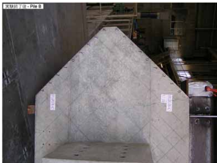
写真-4.24 実験終了後 フーチング上面損傷状況 (Case SPP-C-2, PileB)
