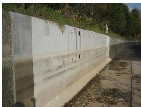
写真-13 樹脂系の施工3年後の状況
