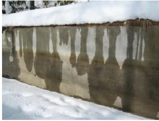
写真-12 冬期間の南向き側壁の状況 (セメントモルタルによる補修区間)
