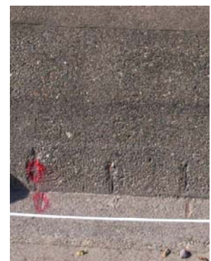
写真-1 コンクリートの剥落、鉄筋露出状況
