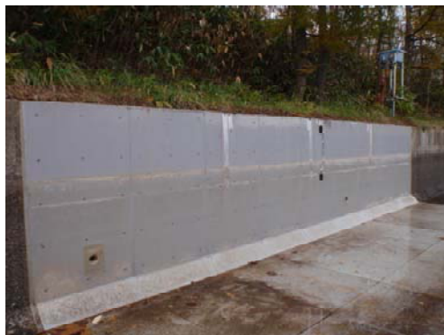
写真-10 FRPM板の施工3年後の状況
