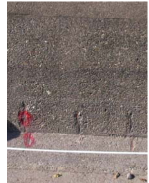
写真-3 コンクリートの剥落、鉄筋露出状況
