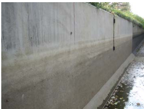
写真-12 モルタル系の施工3年後の状況
