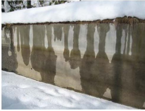
写真-11 冬期間の南向き側壁の状況
