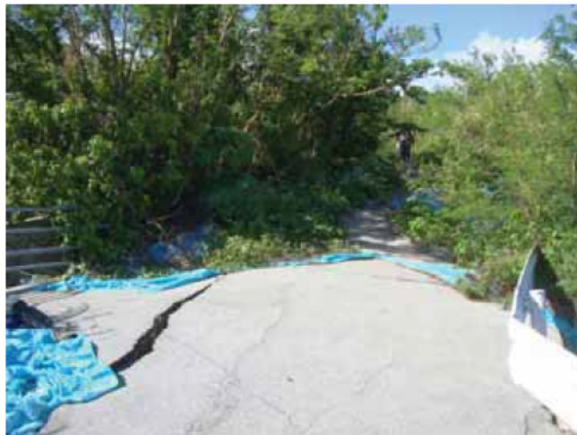
写真 4.2 当間地区の代表的な変状箇所の状況
