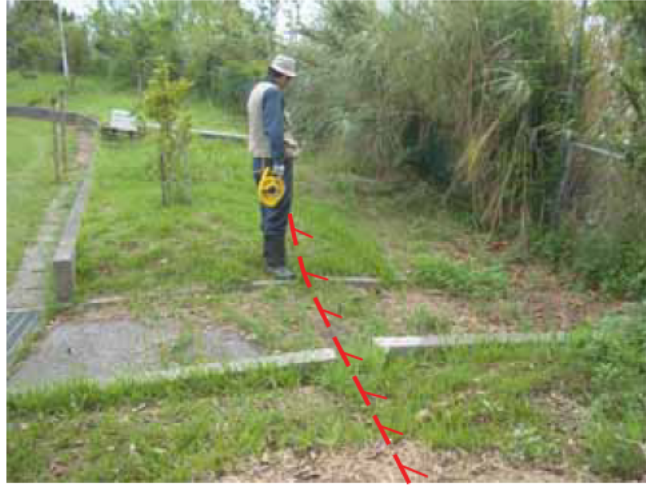
写真 4.1 当間地区の代表的な変状箇所の状況
