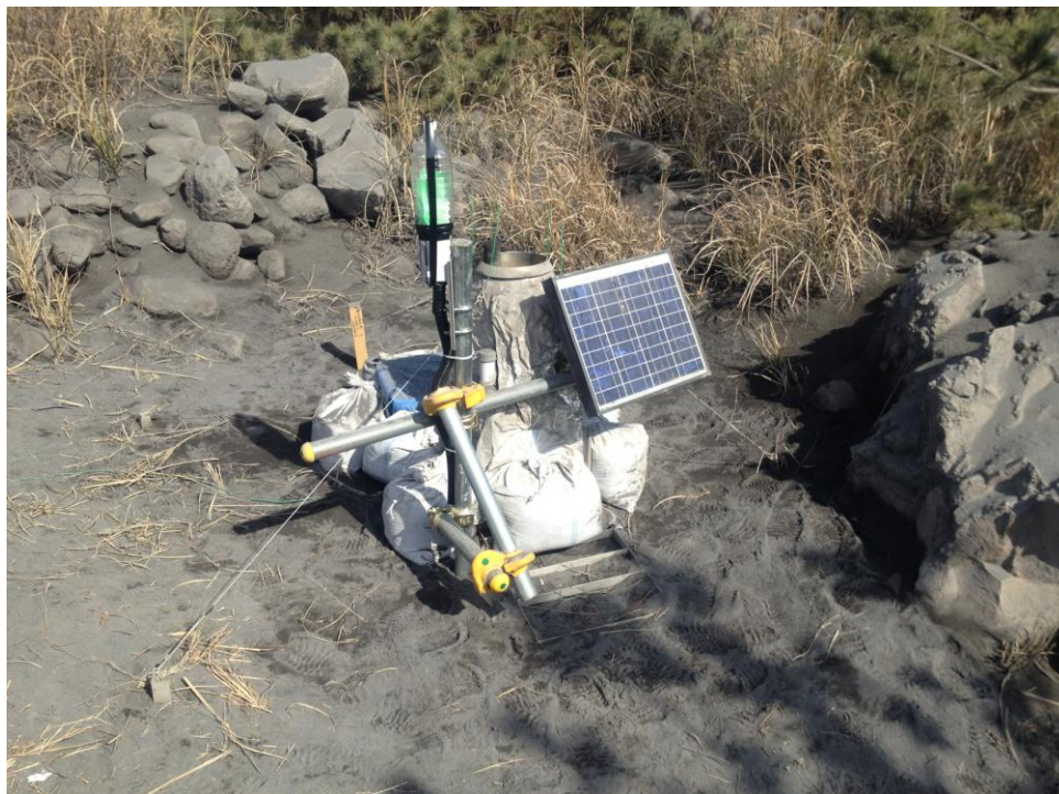
図 10 超小型通信端末設置状況
