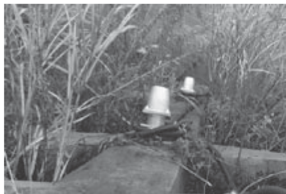
写真 2.7.3 アンカー荷重計の設置状況 (A-1 上段)
