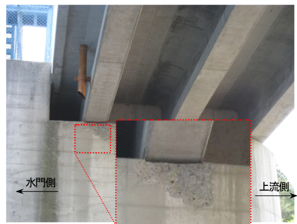
写真 5.1.3 橋座部の損傷状況 (第3径間)
