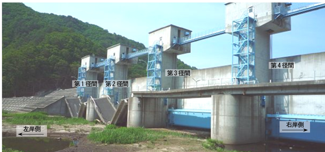
写真 5.1.1 被災直後の状況
