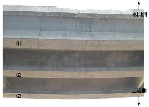
(b) 主桁に多数の曲げひび割れ
