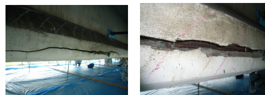
写真 3.1.2 PC桁下フランジ部の劣化状況
