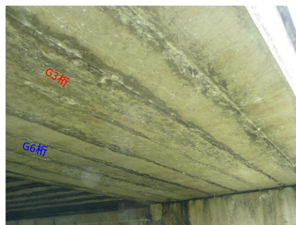
写真4.1.1 本橋桁下面のひび割れ状況
