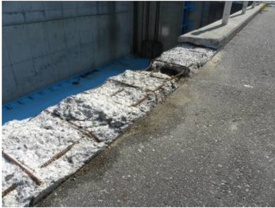
(a) 地覆部の圧壊
