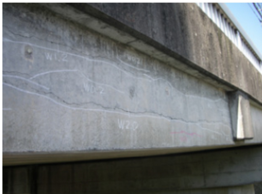
写真 6.2.1 外桁側面に発生した軸方向ひび割れ
