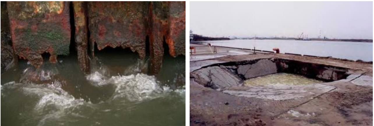
図-1 穴の開いた鋼矢板 (左) と岸壁内部の空洞化によるエプロンの陥没 2) (右)
